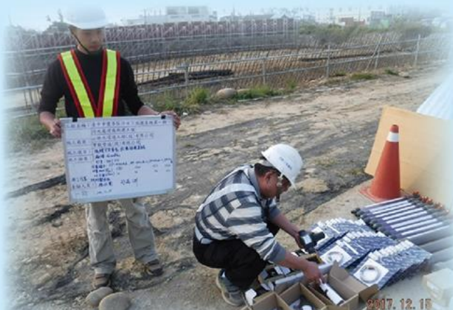
隔膜式定量泵進場抽查
