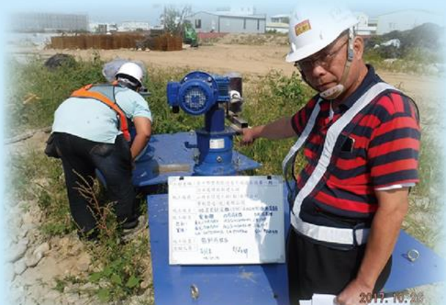
吸泥式刮泥機進場抽查
