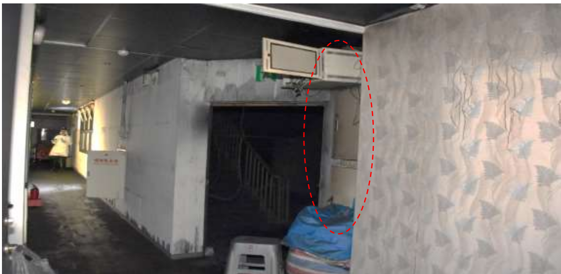
照片 25 8樓僅上半部受輕微煙燻，下半部保有原色；B 梯旁管道間開口密閉。
