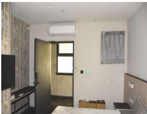
照片（左）西、南側牆面未受燒損。
