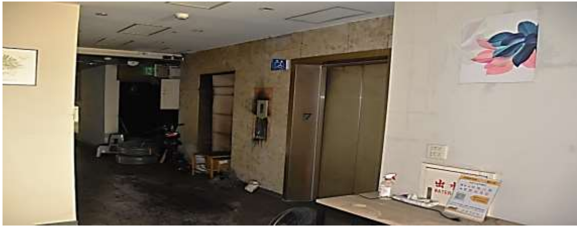
照片 23 7樓僅上半部受輕微煙燻，下半部保有原色。
