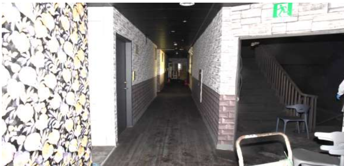
照片 21 6 樓僅上半部受輕微煙燻，下半部保有原色。
