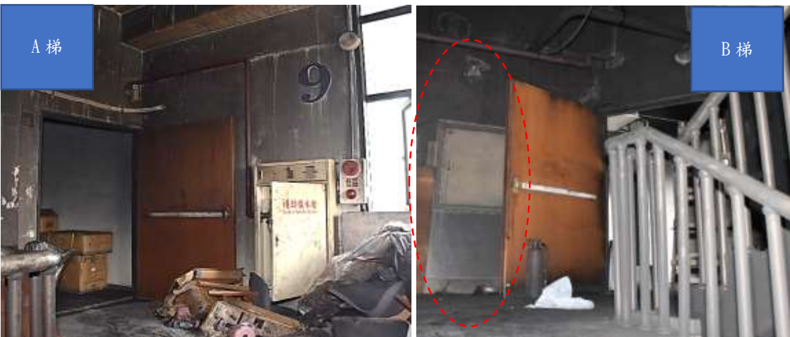
照片 28 (左、右) 9 樓 A、B 梯防火門受些微煙燻，三民路側安全梯內管道間開口密閉，中正路側安全梯間有置雜物情形。
