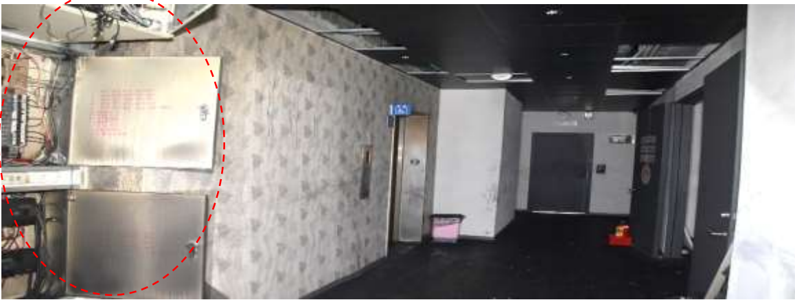
照片 27 9 樓上半部受輕微煙燻，下半部保有原色，B 梯旁管道間呈密閉狀態。
