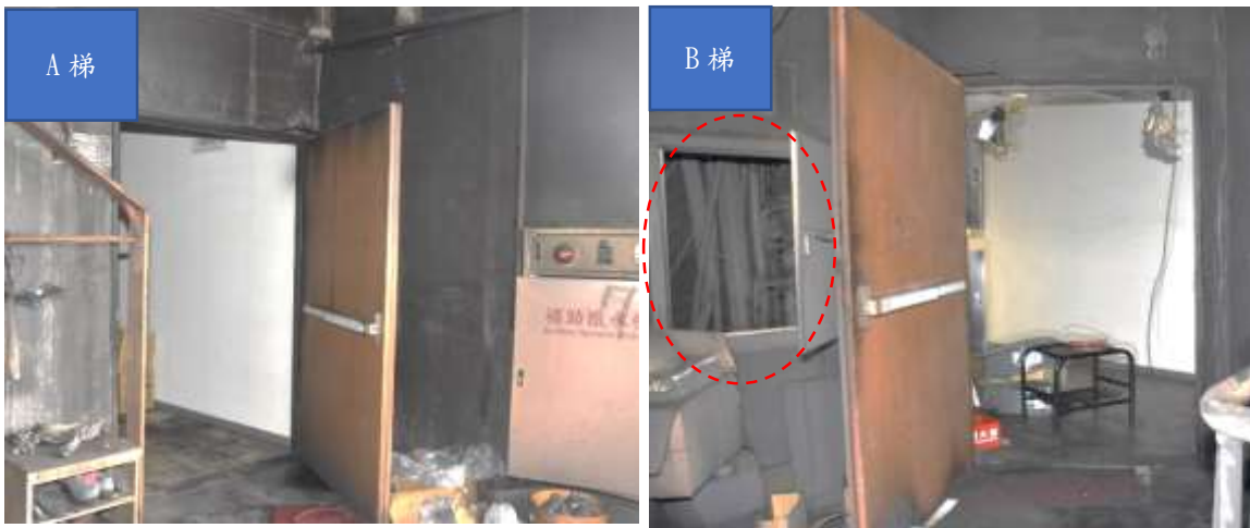
照片 24 7樓 A、B 梯防火門受些微煙燻，B 梯旁管道間密閉，2 座安全梯均有堆置雜物情形。
