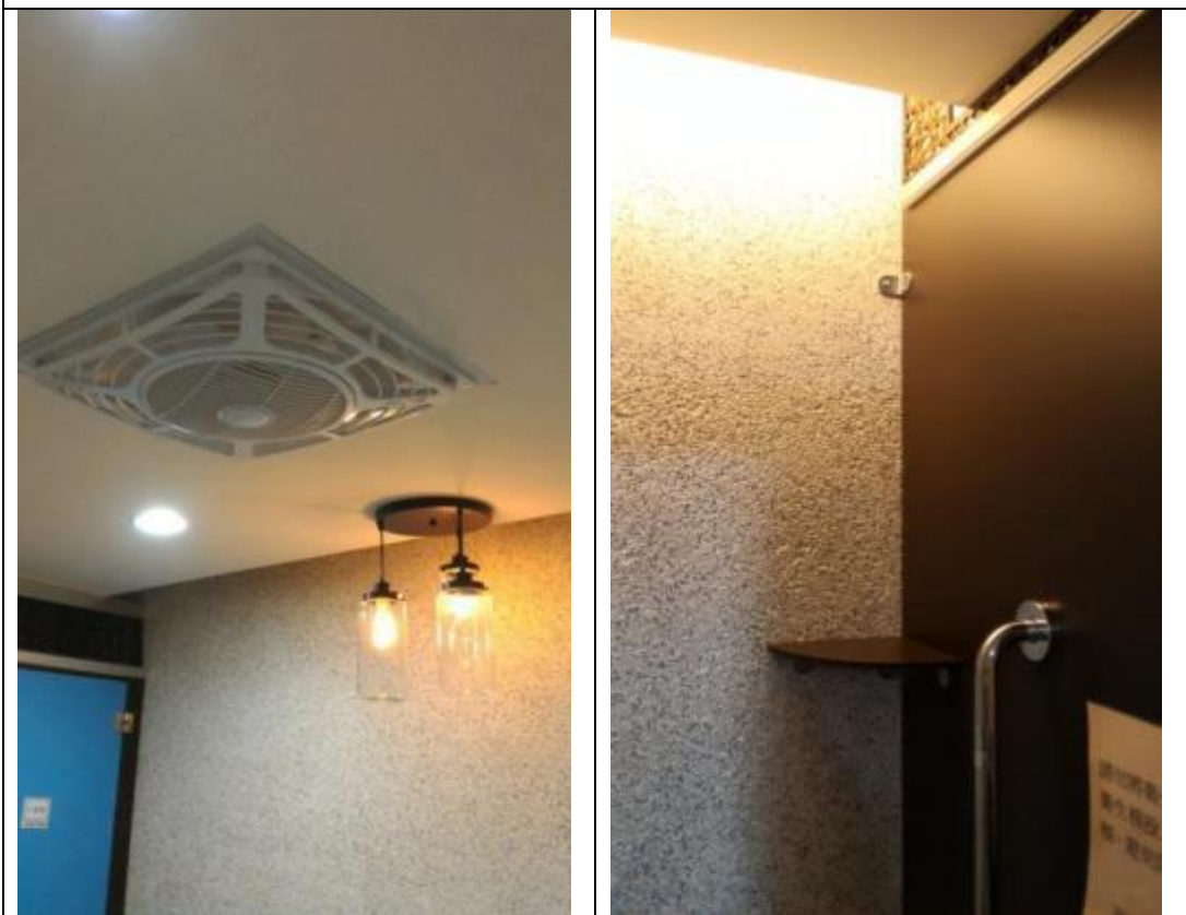
圖 13-5 廁所內採機械換氣，減少廁所臭味。(來源：內政部建築研究所，104)
