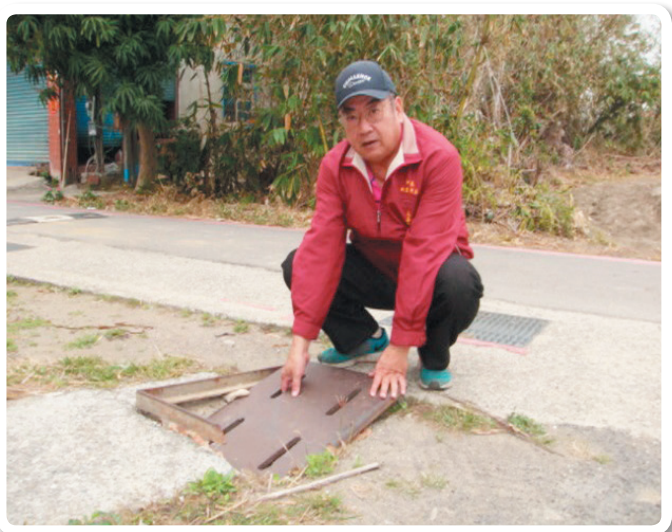
陳里長勘查水溝蓋破損情形
