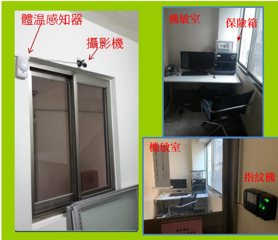
圖 2-9 亞新公司機敏室設置照片
