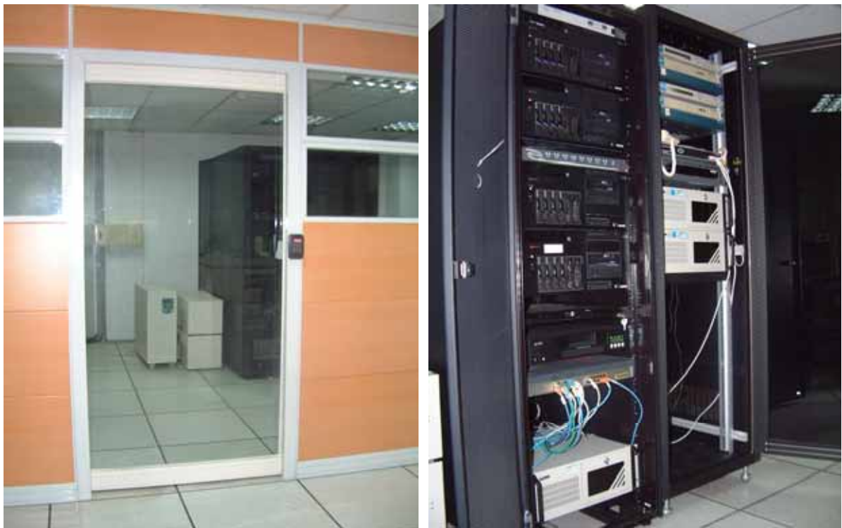
圖 3-3 e-GPS 控制及計算中心資訊機房實景相片
