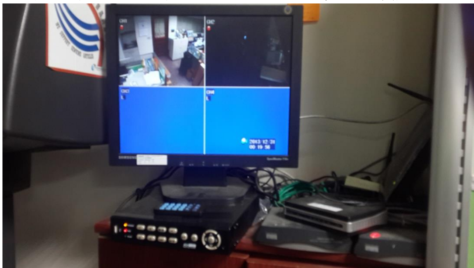
附圖 5 24 小時錄影監視畫面及錄影機一台
