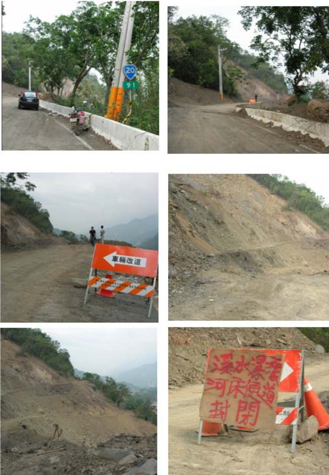
圖 3.2-5 台 20 南橫公路里程 91K 崩塌狀況圖
