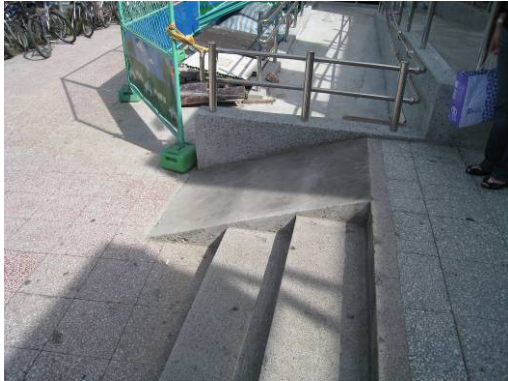
原坡道極陡，新設坡道已改善（未完工）
