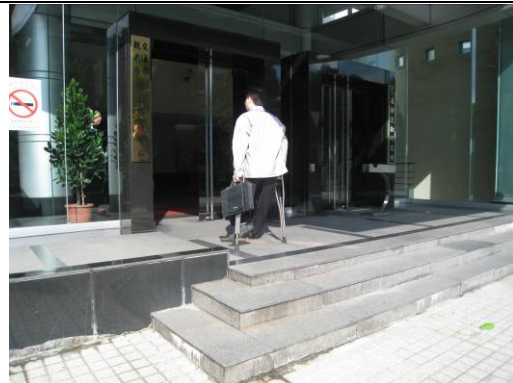
入口階梯無扶手
