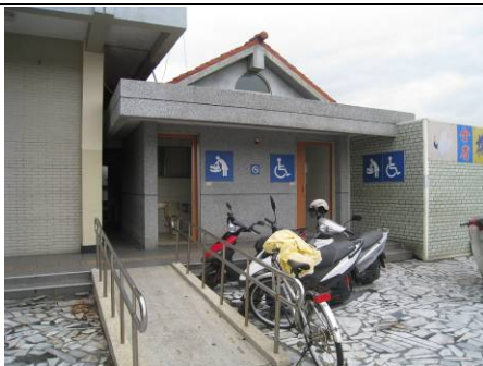
馬桶兩側設固定扶手，輪椅無法進入
