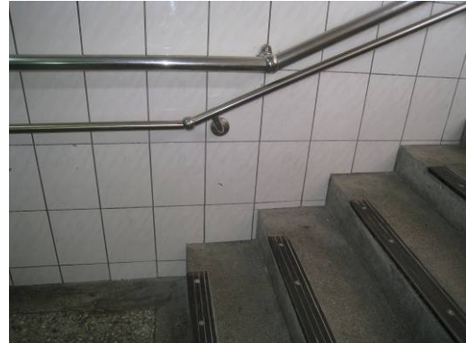
樓梯扶手原太粗、太高，已改善
