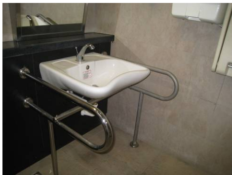
洗面盆扶手支柱影響輪椅接近
