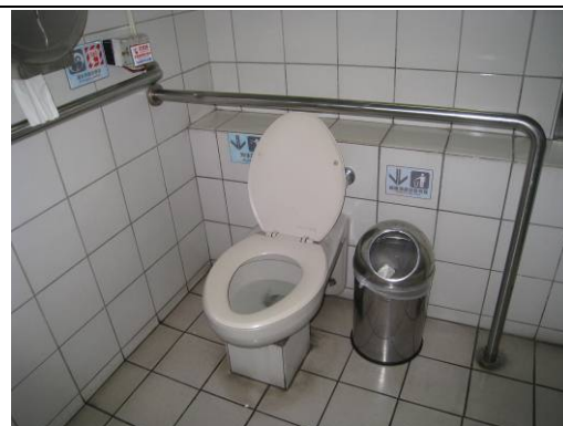
廁所扶手設置不佳
