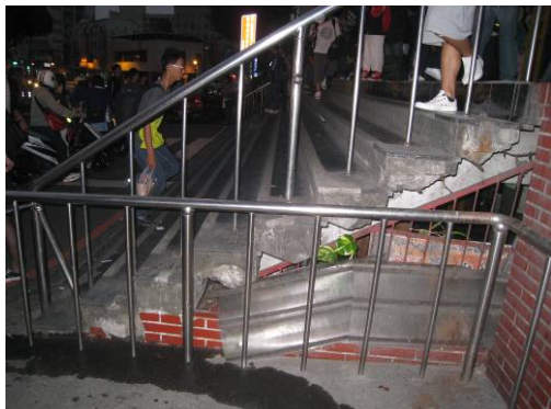
車站入口高差極大約 1.4 公尺
