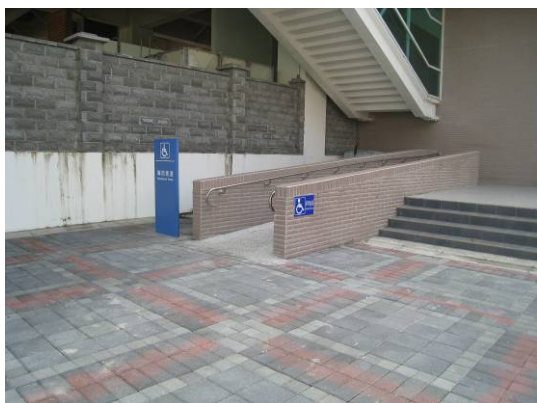
車站入口坡道高差約 60 公分
