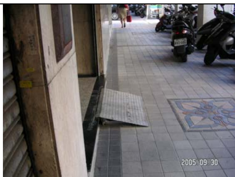
設置固定式消坡版，造成騎樓障礙 照片來源：本研究攝
