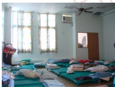
室內日曬嚴重，無遮陽措施
