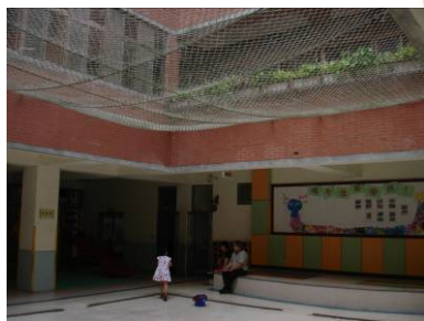
戶外走廊均齊度不足，晝光使用效率差
