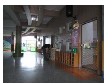
教室走廊照度不足
