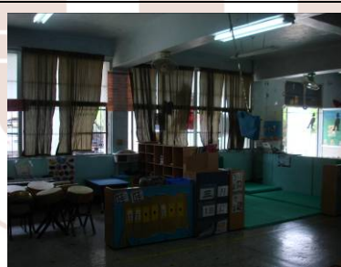
室內部份空間照度不足
