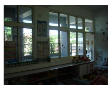
燈具分配不均不足，導致室內照度不佳，均齊度不佳
