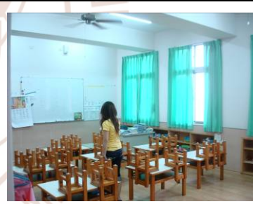
教室西曬延重，空調效率不足
