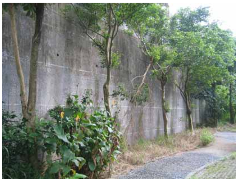
照片 5-7 案例一 D 擋土牆外觀
