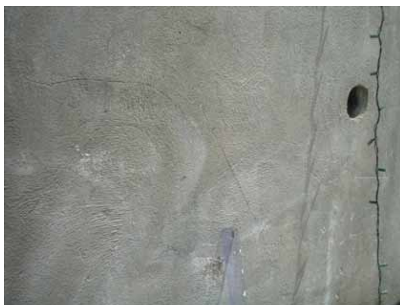
照片 5-3 案例一 A 擋土牆局部裂縫
