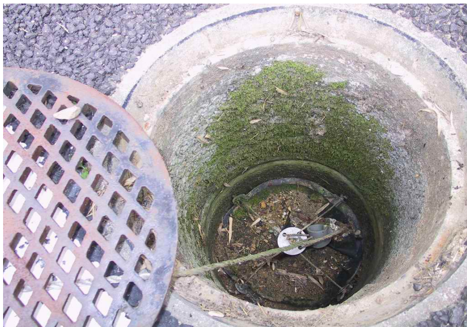
圖 5-38 滲透陰井的攔污設備(2)
