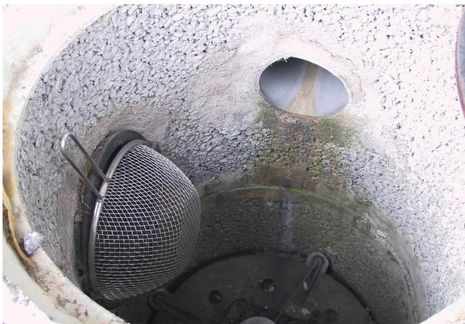
圖 5-37 滲透陰井的攔污設備(1)
