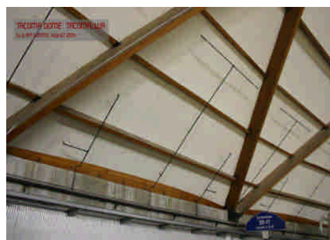
(d) 底層消防撒水系統管路
