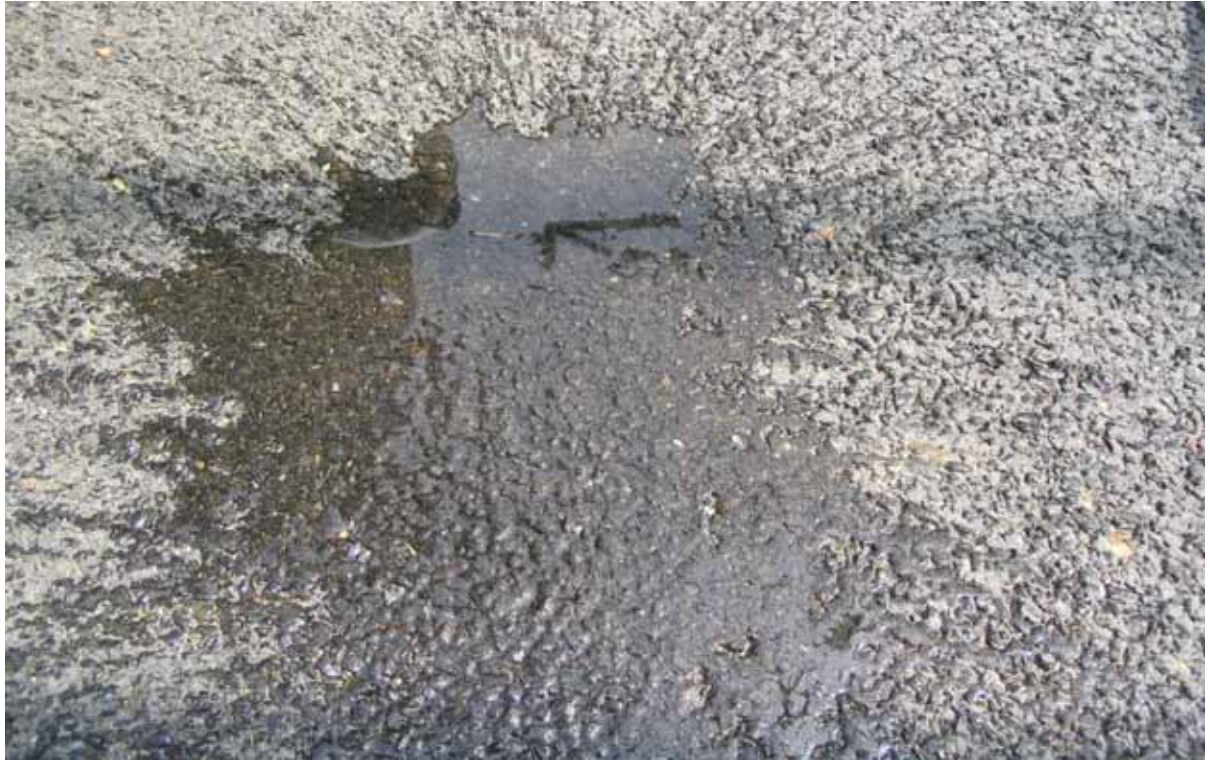
圖5-11 多孔滲瀝青混凝土灰塵阻塞
