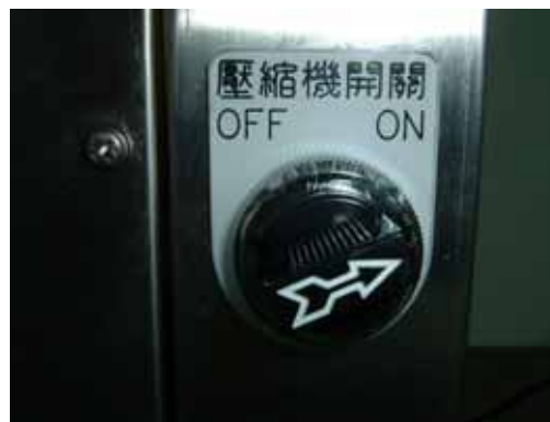
圖 2-37 冰水壓縮機開關
