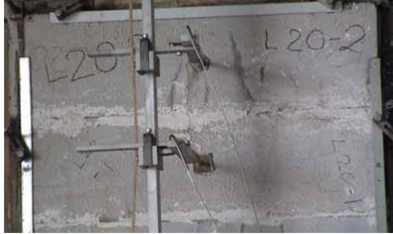
照片 5-8 混凝土版背熱面之破壞情形
