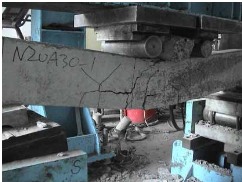
照片 4-6 常重混凝土樑試體破壞情形(a/d=3.0)
