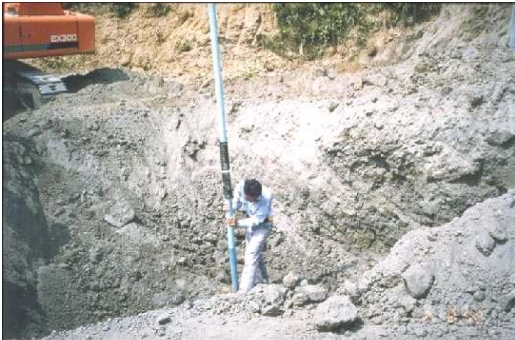
圖 8.1 填土區傾斜觀測管
