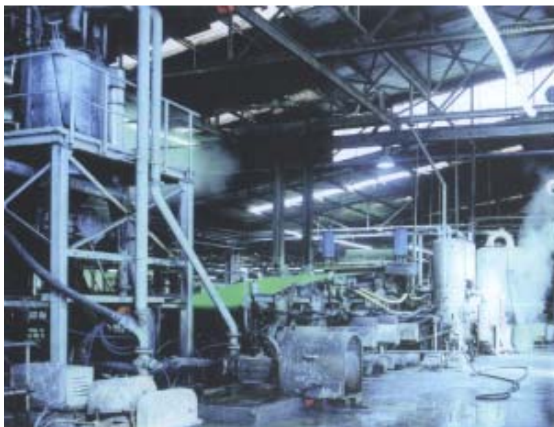
圖 3.45 廠型的 Hatschek Machine 抄造機處理情景
