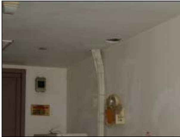
圖 3.11 高層建築訪視照片 - 管道間之防火防煙區劃破壞
