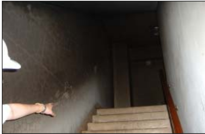
圖 2.8 敦南富邑大樓火場內部（樓梯間）
