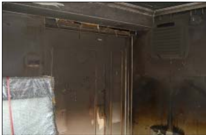
圖 2.9 敦南富邑大樓火場內部（電梯間）
