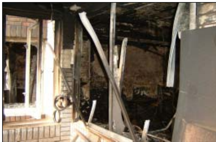
圖 2.7 敦南富邑大樓火場內部（陽台）
