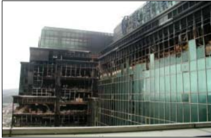
圖 2.3 汐止東方科學園區受災情形 - 自 C 棟大樓看 A 棟及 B 棟火害情形
