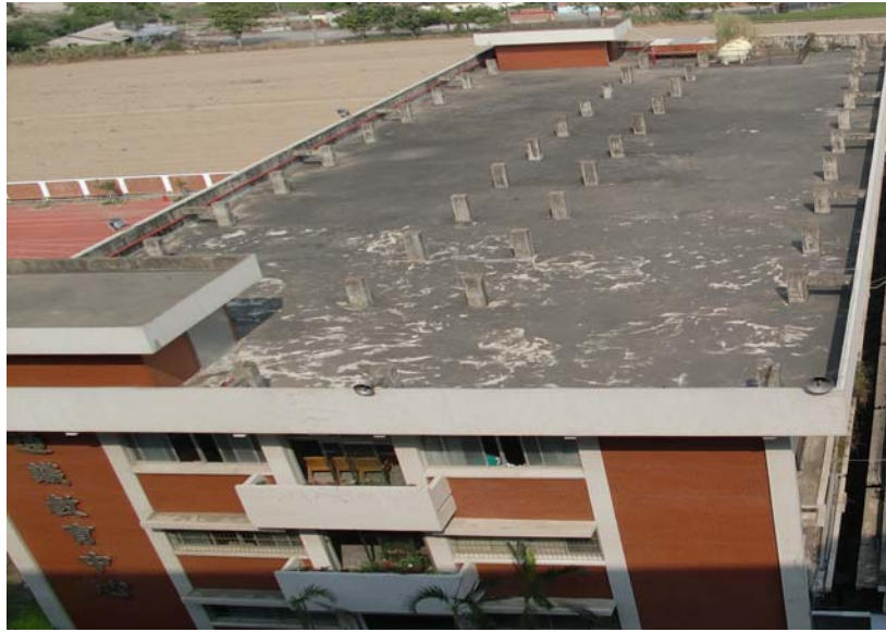
圖 4-8 顯著的防水層缺陷散佈在屋頂上
