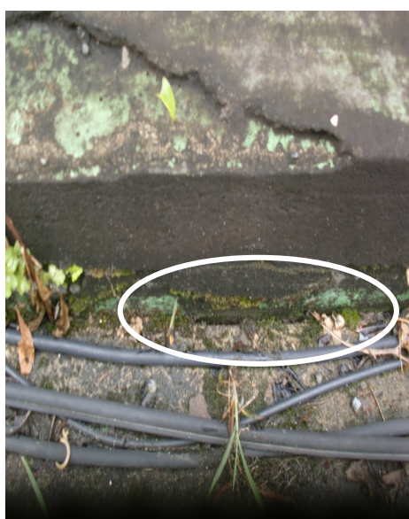
圖 4-5 把草拔除後可以看到草的根已經深入女兒牆與屋頂板間的接縫，防水層當然已經被草根破壞了。
