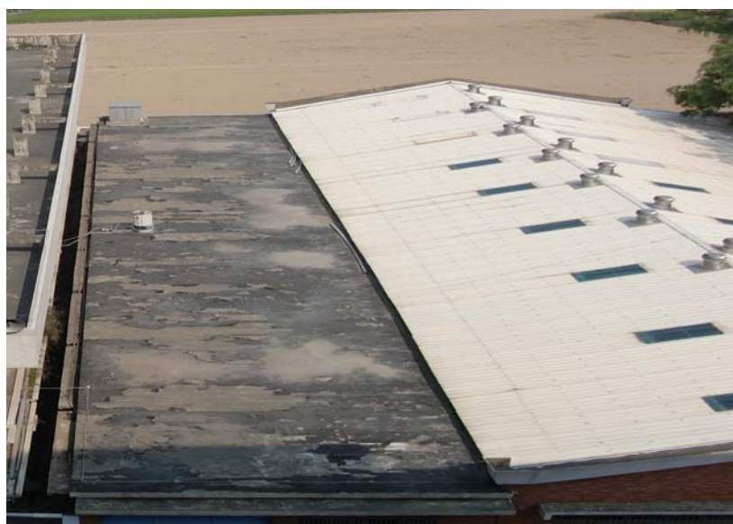
圖 4-7 缺陷明顯且廣範圍存在屋頂上
