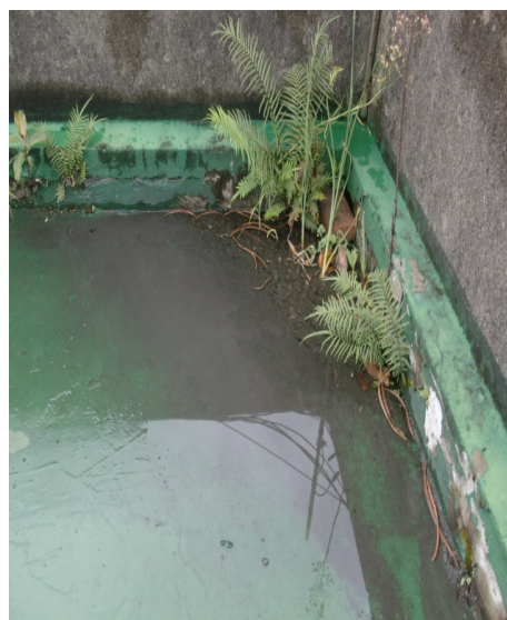
圖 4-4 排水不良且有 20CM 上的草木生長 資料來源：本研究拍攝
