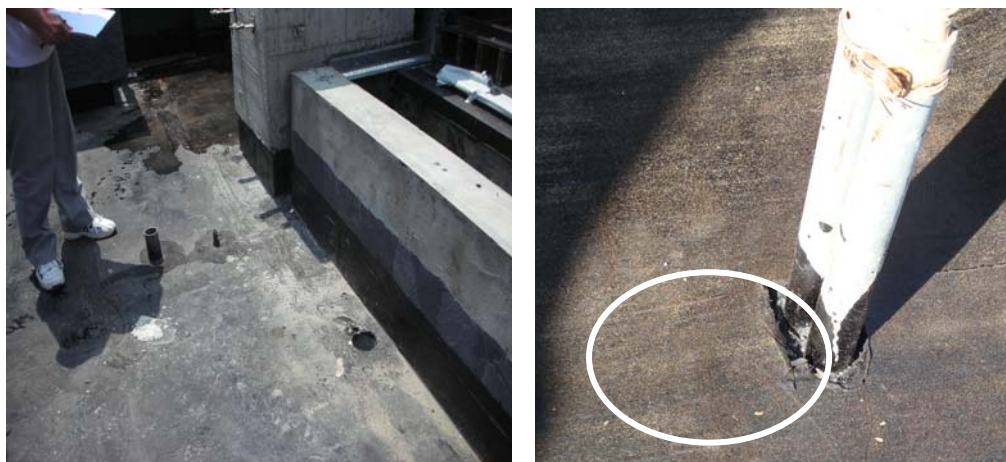
圖 4-23 過多的管材穿過屋頂板 圖 4-124 管材穿過樓板處錯誤的防水材料施工法
