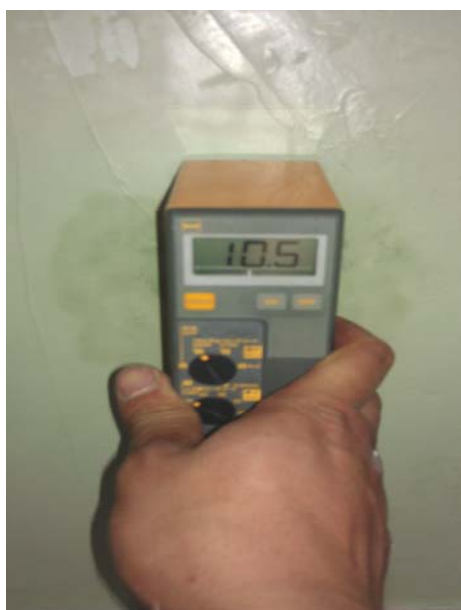
圖 4-33 牆壁含水率極高 日本 KETT HI-520 溼度計
