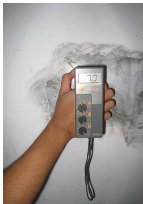
圖 4-32 牆壁含水率呈潮溼狀態 日本 KETT HI-520 溼度計
