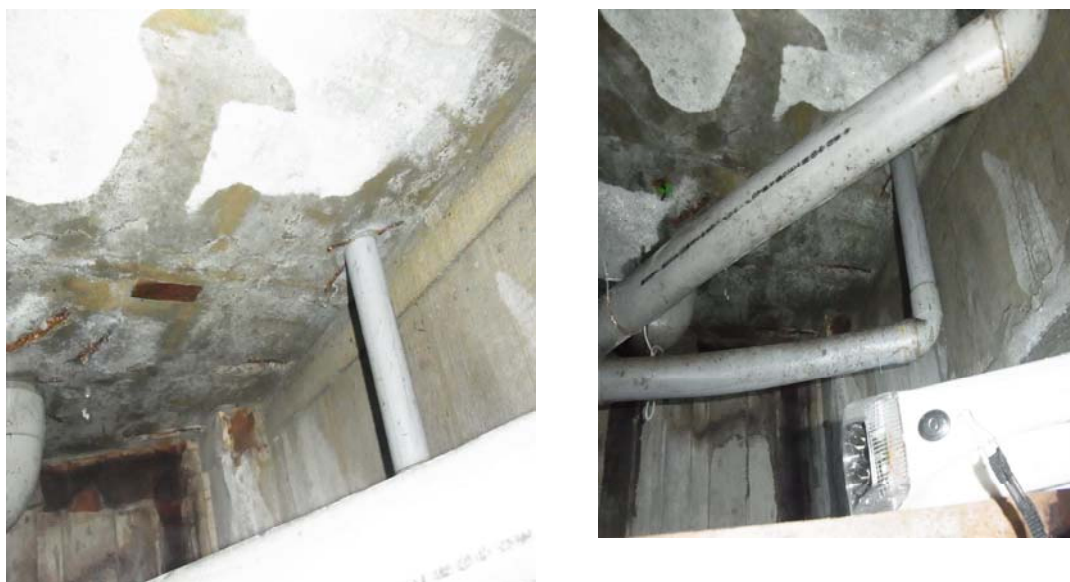
圖 4-81 浴室地坪防水已經老化造成下層住戶之浴室頂版的漏水現象
