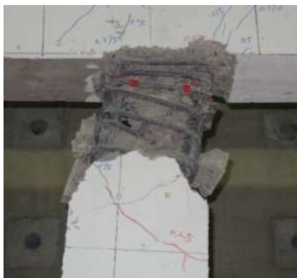
圖 4- 118 門及窗間之小柱塑鉸區破壞情形
