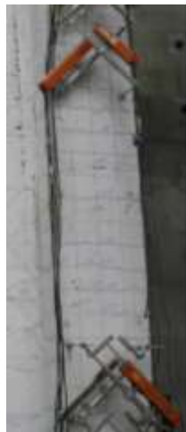
圖 4- 37 柱部分裂縫延伸至另一面
