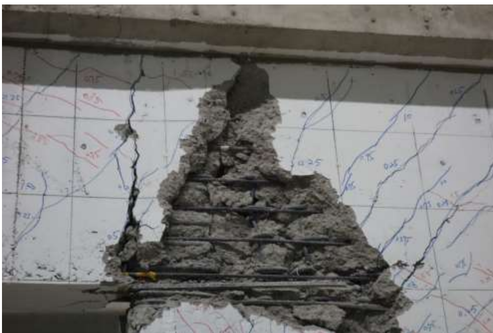
圖 4- 102 壓桿承壓區破壞往上擴展
