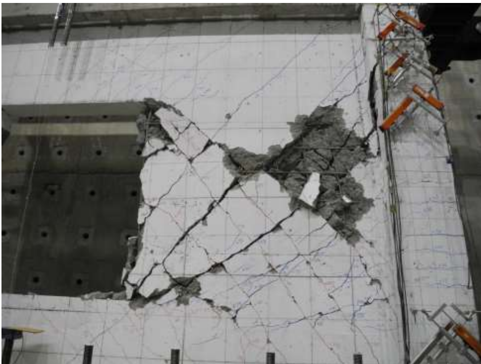
圖 4- 56 牆體正負向壓桿交會區嚴重剝落
