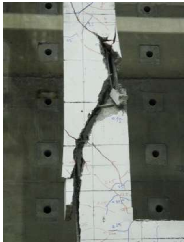
圖 4- 53 窗與門間之小柱嚴重剪力破壞
