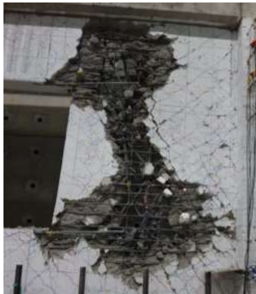
圖 4- 116 關鍵斷面區破壞情形
