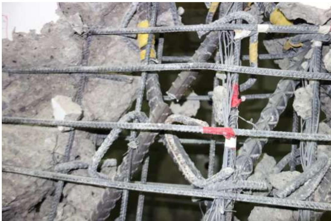
圖 4- 117 第二支對角向鋼筋拉斷
