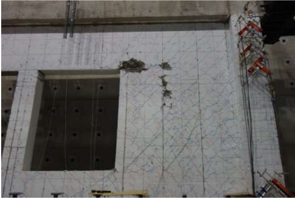
圖 4- 90 窗右上角(壓桿承壓區)保護層剝落
