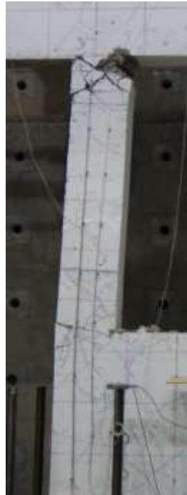
圖 4- 103 開口間小柱由剪力破壞轉為撓曲破壞，上緣產生塑鉸 (資料來源：本研究拍攝)
