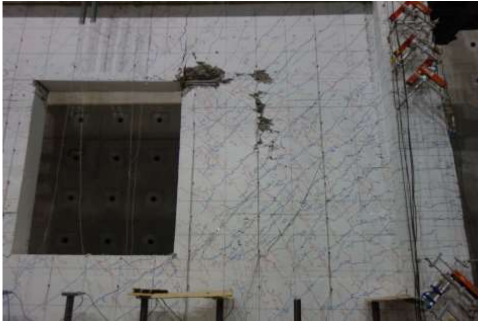
圖 4- 93 負向壓桿承壓區持續剝落，裂縫密布於關鍵斷面區 (資料來源：本研究拍攝)
