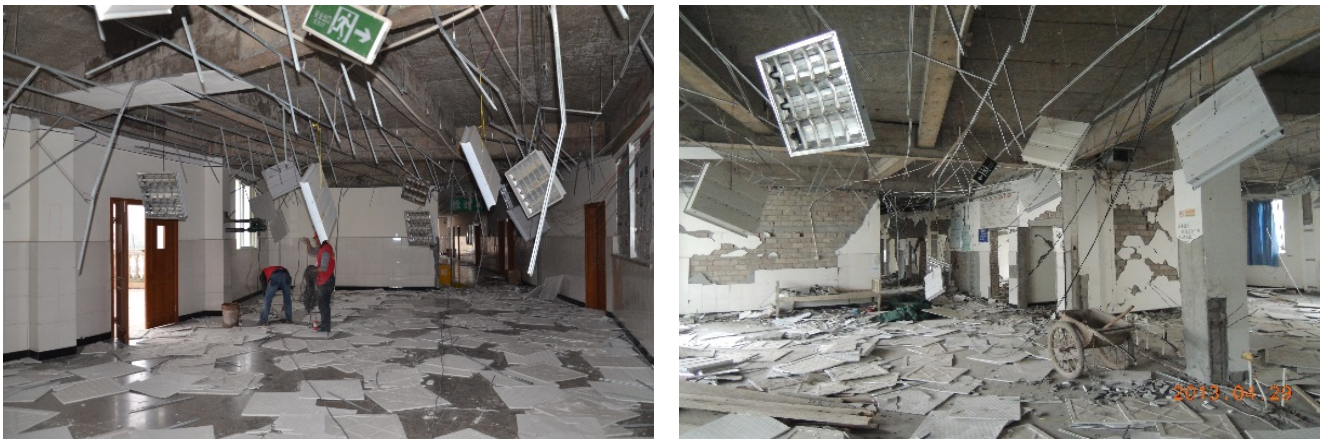
圖 2-8 蘆山縣人民醫院天花板受損情形 (資料來源：林克強等，2013)
