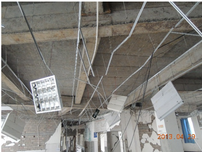
圖 2-28 支承於懸吊式系統天花 於震後掉落之照明燈具 (資料來源：林克強等，2013)
