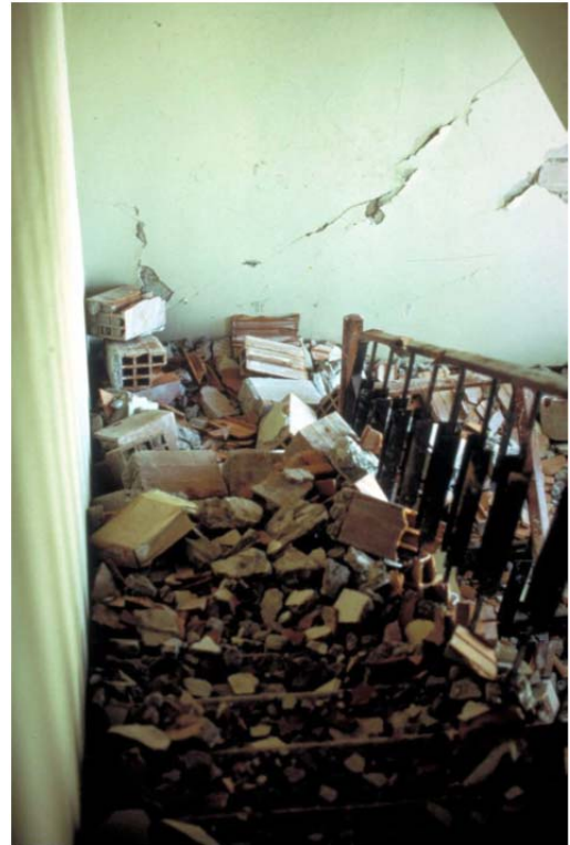
圖 2-15 梯間構材掉落影響動線 (資料來源：ATC, 2011)
