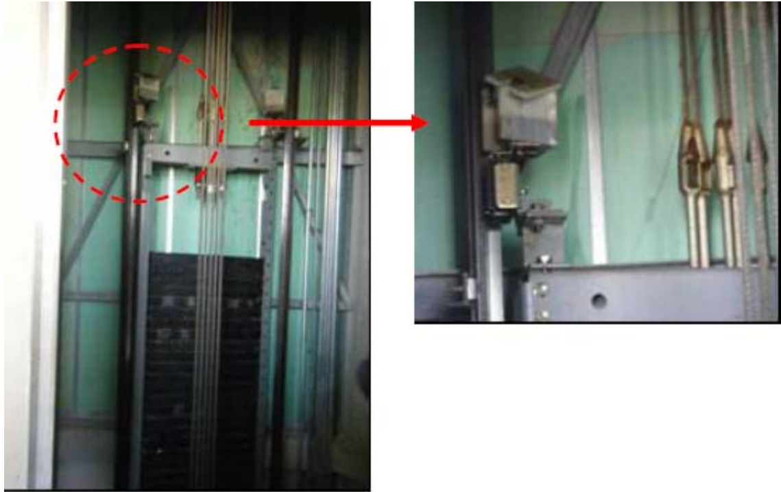
圖 2-40 電梯配重塊脫軌 (資料來源：邱聰智等，2010)
