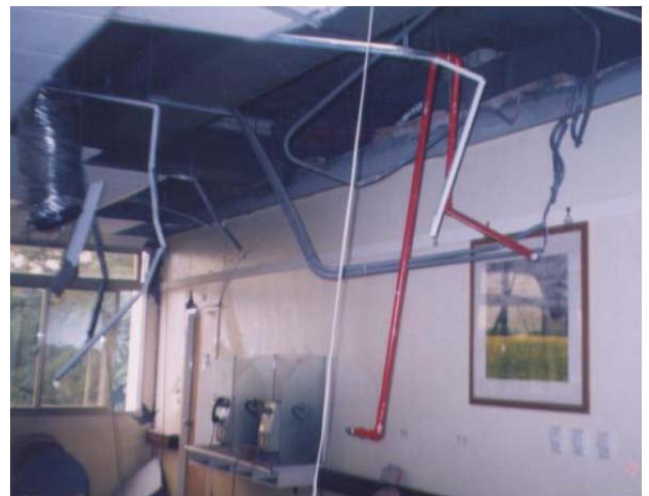
圖 2-22 消防管線斷裂掉落 (資料來源：姚昭智)
