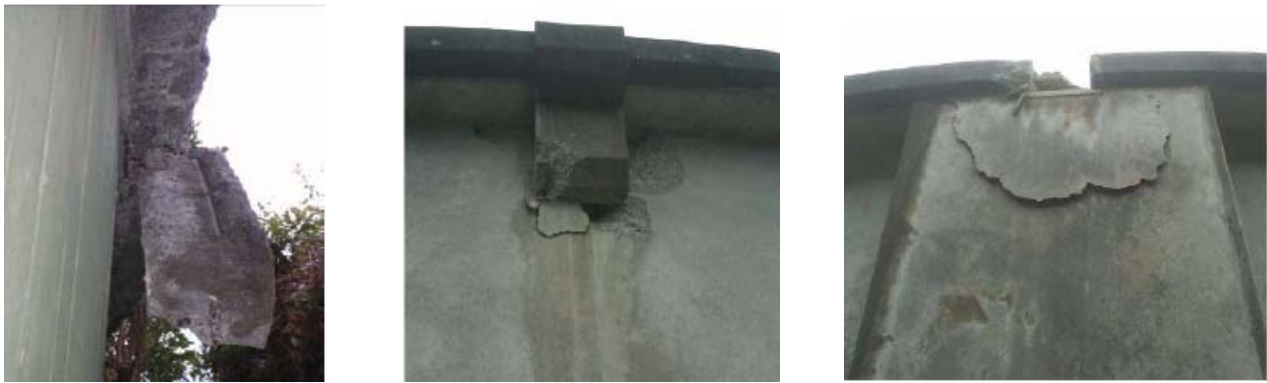
(f)頂部懸臂板斷裂 (g)頂梁與牆交界面損壞 (h)外柱混凝土破壞
