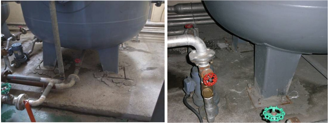
圖 2-18 熱水儲槽之基礎混凝土龜裂，固定螺栓拉拔鬆脫 (資料來源：宋裕祺等，2010)
