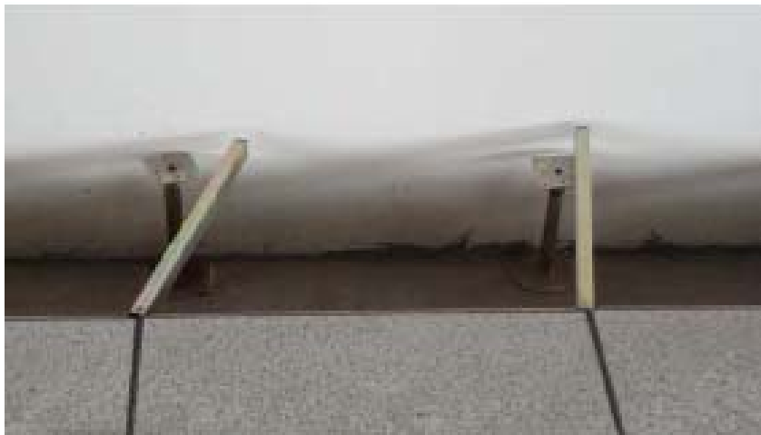
圖 2-39 高架地板與相鄰牆面撞擊，桁樑與基座固定處脫開 (資料來源：ATC, 2011)
