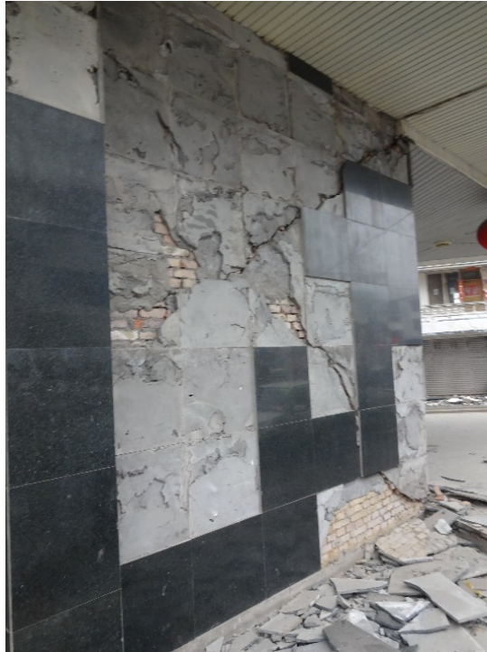
圖 2-1 蘆山縣政府外牆損毀情形 (資料來源：林克強等，2013)
