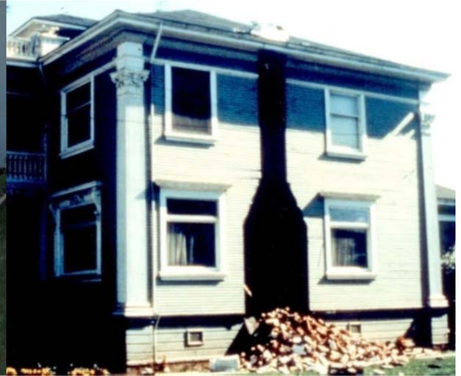
圖 2-13 磚造煙囪崩塌 (資料來源：ATC, 2011)
