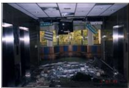
圖 1-1 掉落之玻璃磚牆 (資料來源：姚昭智)
