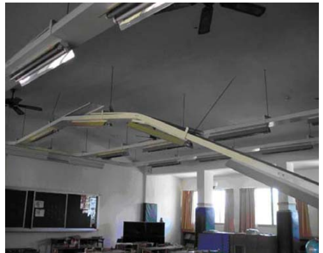
圖 2-29 固定於上方樓板底部之 懸吊照明設備破壞情形 (資料來源：宋裕祺等，2010)
