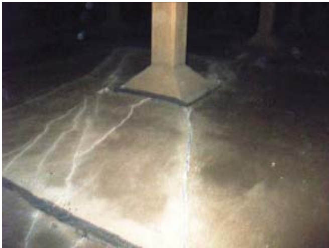
(a)底板開裂
