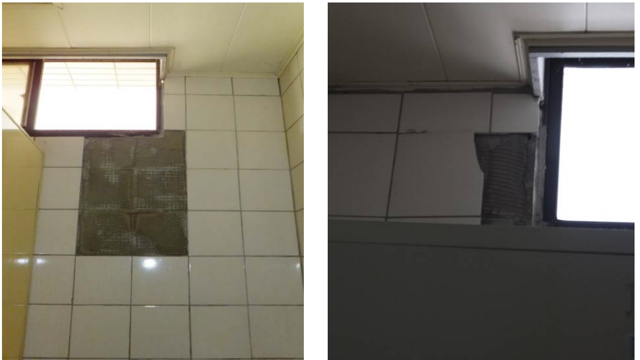
圖 2-6 二樓女廁瓷磚掉落
