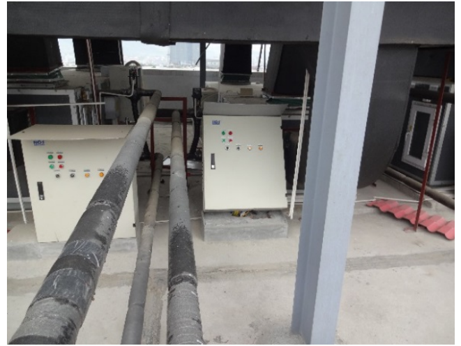
圖 2-17 屋頂電力控制盤傾倒 (資料來源：林克強等，2013)
