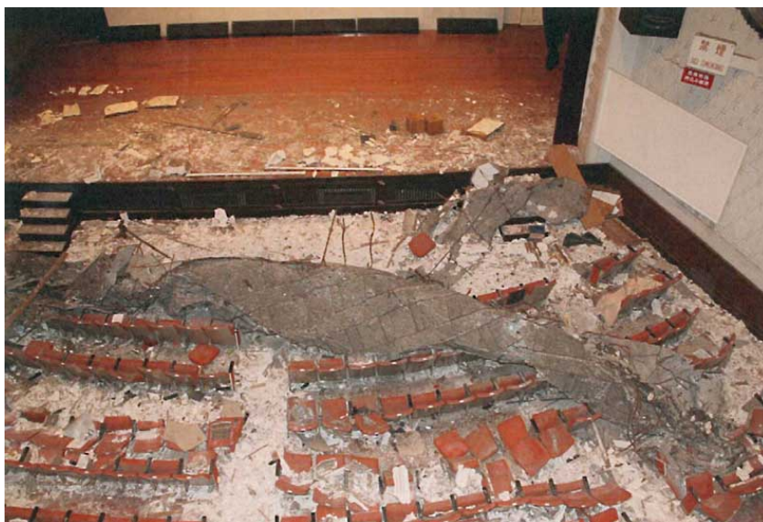
圖 2-9 日本東京九段會館天花板掉落 (資料來源：日本國土交通省，2011)
