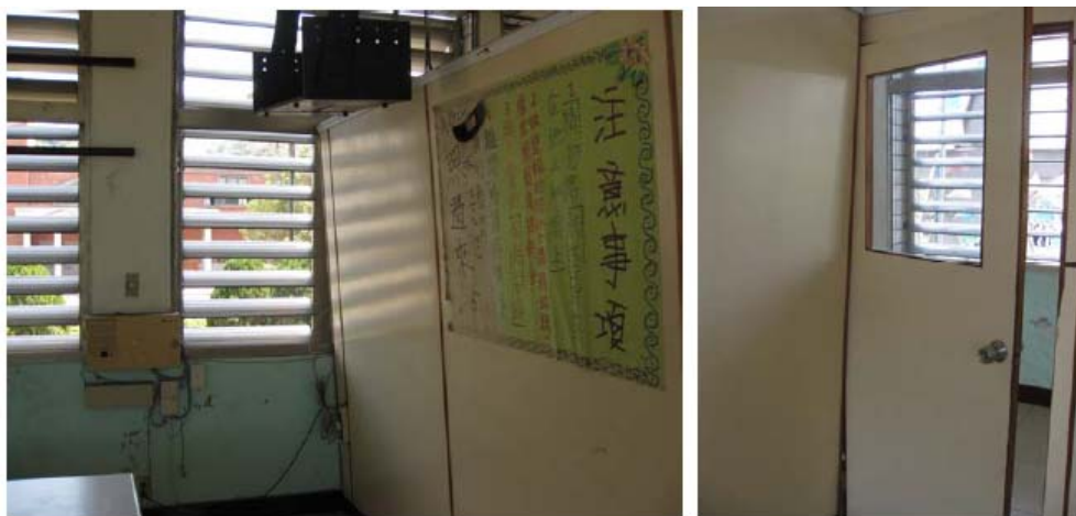
圖 2-5 輕隔間牆歪斜，門無法開啟 (資料來源：宋裕祺等，2010)
