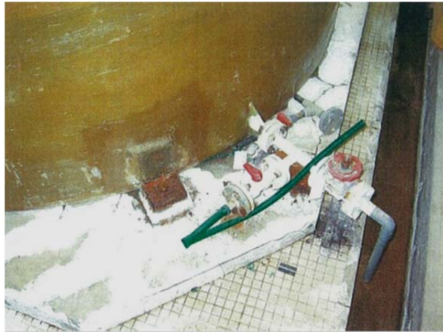
圖 2-44 日本能登半島地震上野淨水場次氯酸鈉儲槽損壞情形 (資料來源：日本水道技術研究センタ)
