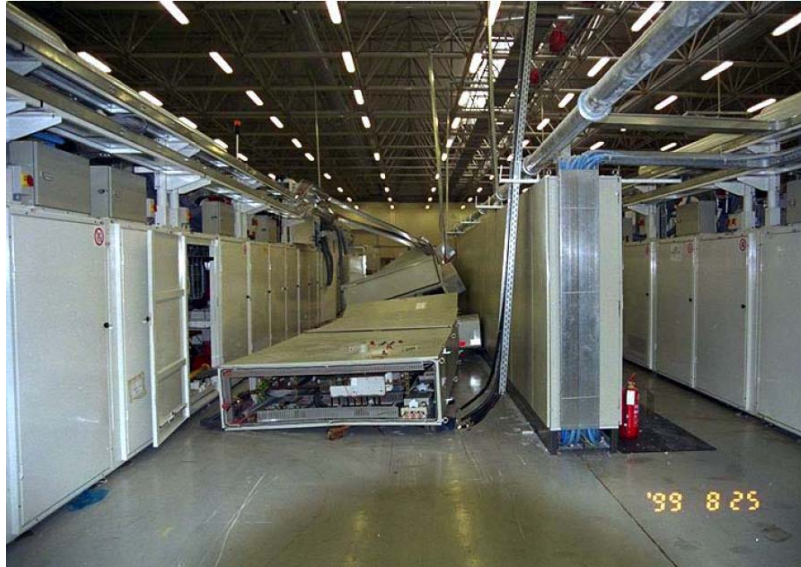
圖 2-27 通訊設備傾倒損壞 (資料來源：ATC, 2011)
