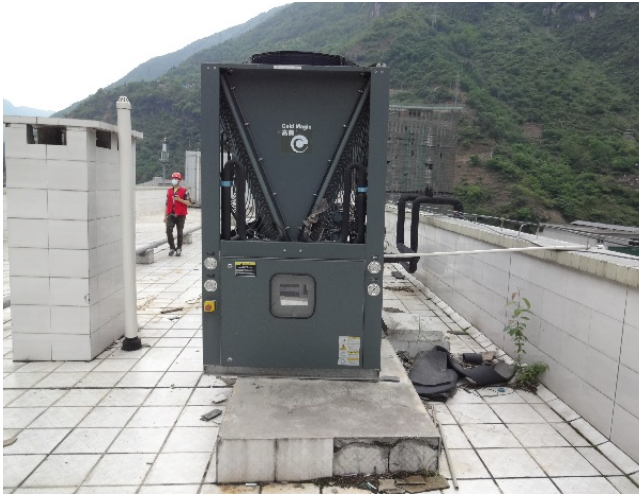
圖 2-16 屋頂電力設備位移 (資料來源：林克強等，2013)
