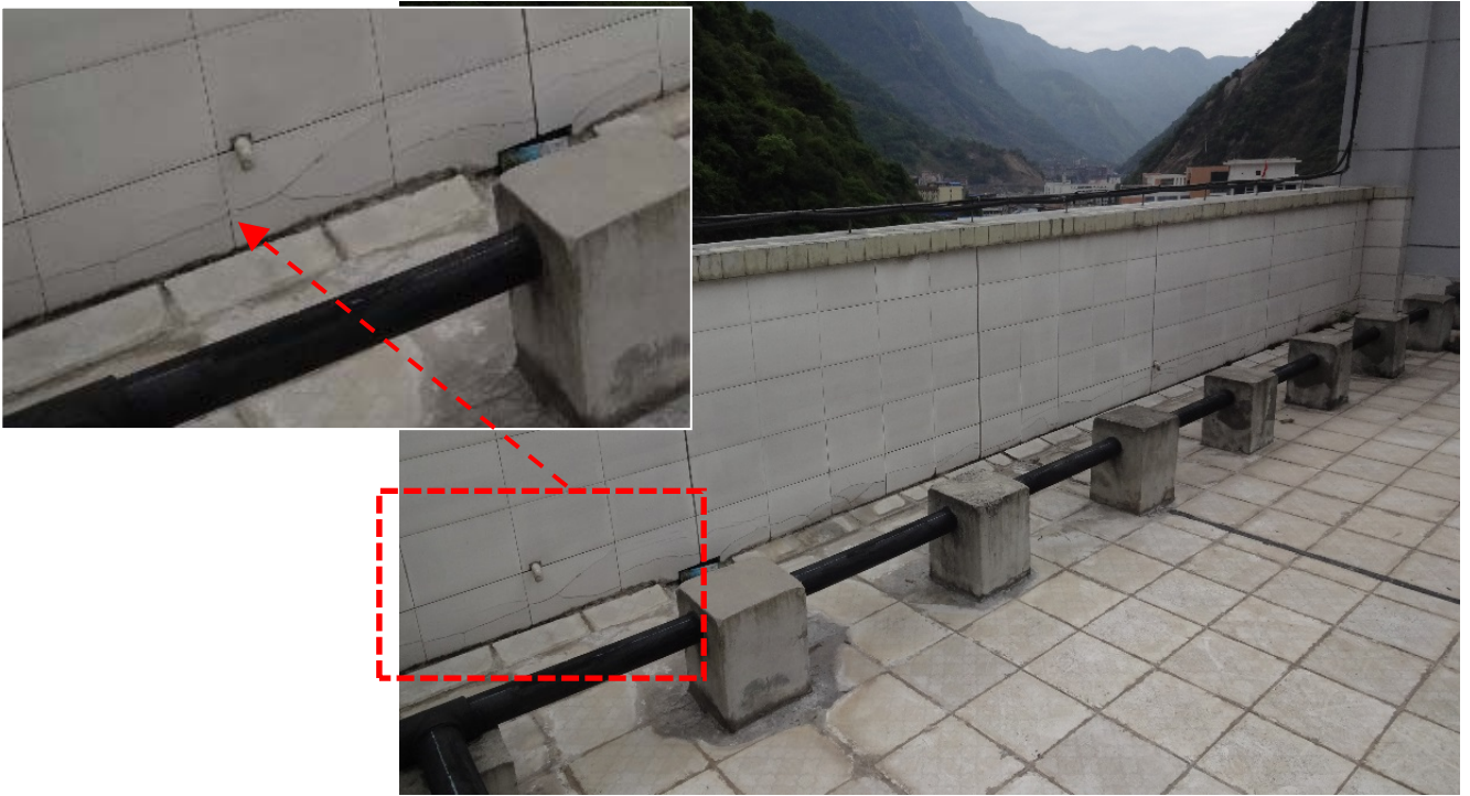
圖 2-10 屋頂女兒牆底部開裂 (資料來源：林克強等，2013)
