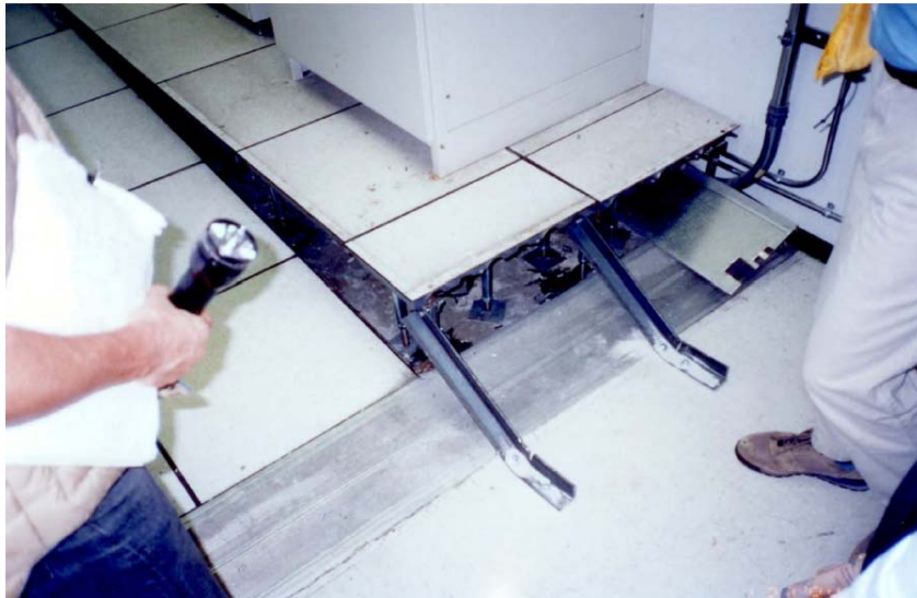
圖 2-38 高架地板倒塌 (資料來源：ATC, 2011)
