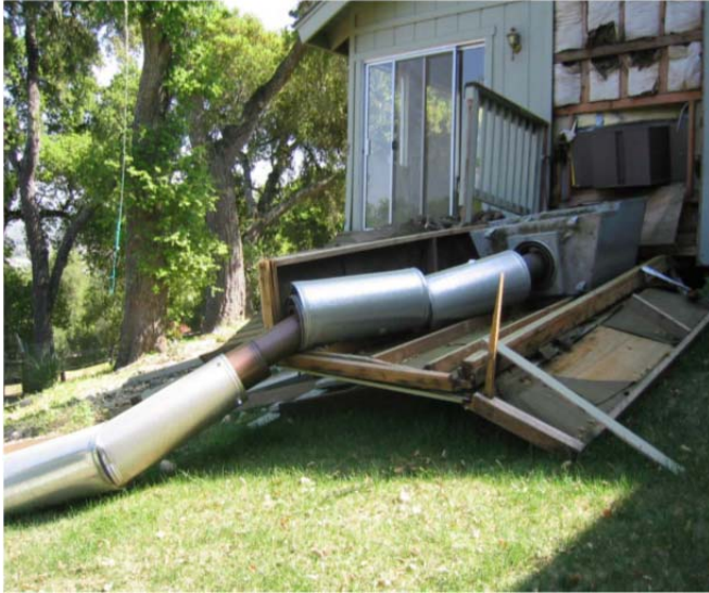
圖 2-12 煙囪傾倒損及建物 (資料來源：ATC, 2011)
