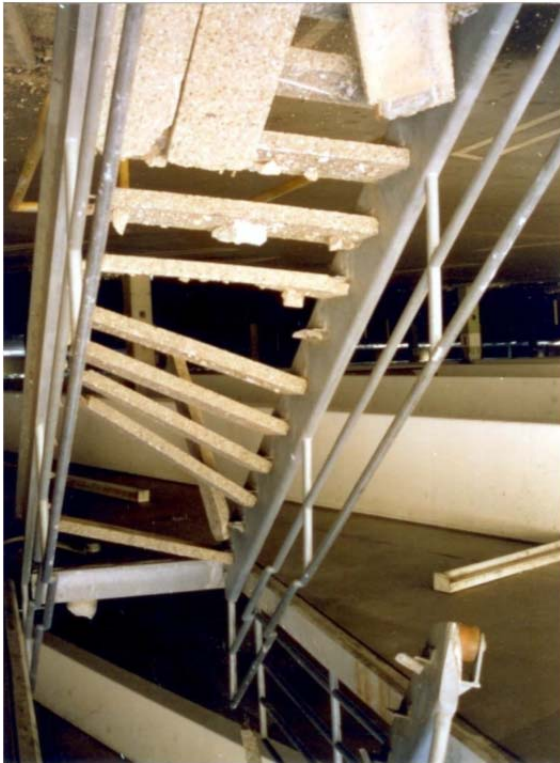
圖 2-14 結構獨立樓梯損壞情形 (資料來源：ATC, 2011)
