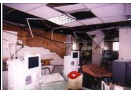
圖 1-2 遭破壞之洗腎室 (資料來源：姚昭智)
