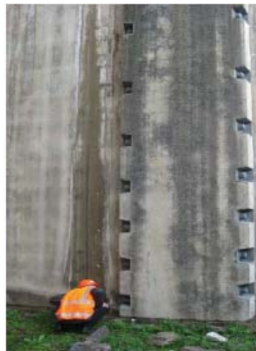
(d)牆體開裂滲漏
