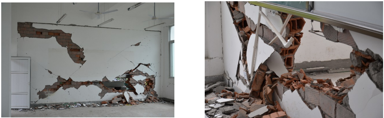
圖 2-4 空心磚隔間牆牆體崩塌 (資料來源：林克強等，2013)
