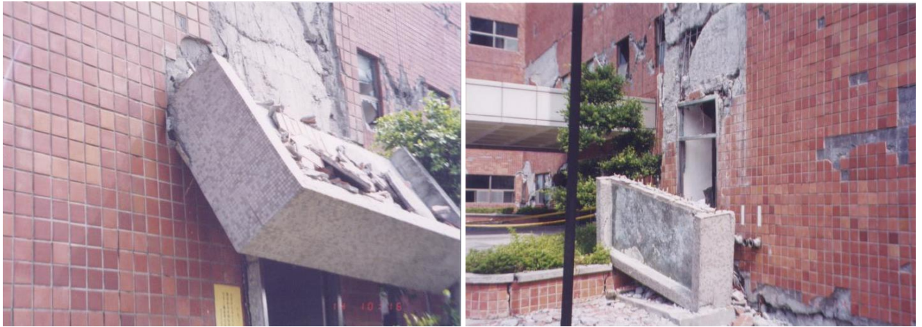
圖 2-11 通道出口上方雨遮掉落 (資料來源：姚昭智)
