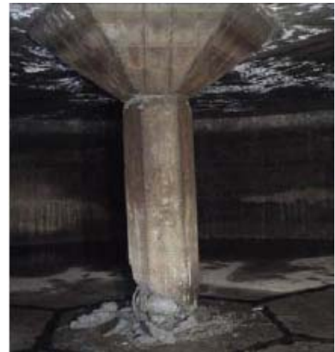
(b)池內柱底破壞
