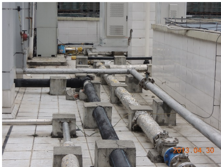
圖 2-23 管線與固定之混凝土撞擊 (資料來源：林克強等，2013)
