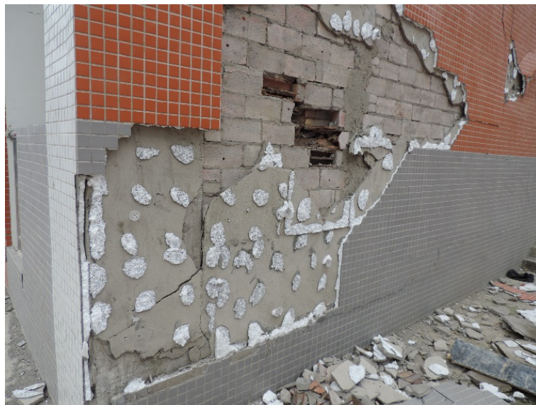
圖 2-2 蘆山縣太平中學外牆損毀情形 (資料來源：林克強等，2013)
