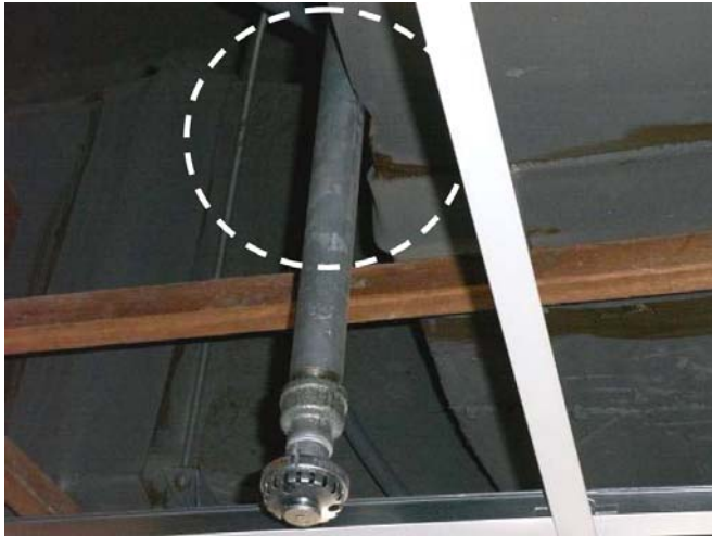
圖 2-24 風管與消防管線相互撞擊 (資料來源：宋裕祺等，2010)
