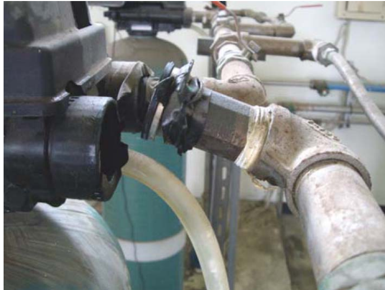
圖 2-20 RO 水過濾桶與水管相接處斷裂 (資料來源：宋裕祺等，2010)
