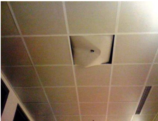
圖 2-21 管線拉扯天花嵌板導致變形 (資料來源：邱聰智等，2010)
