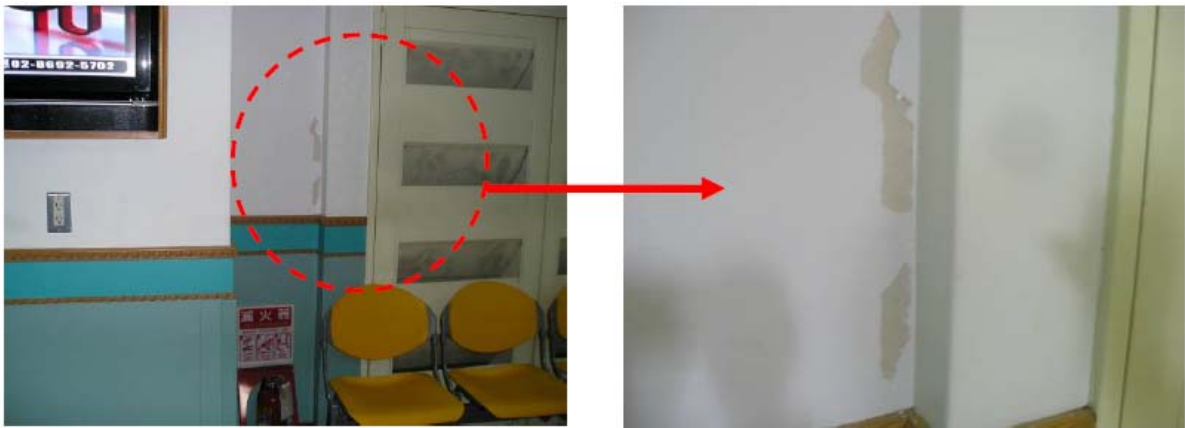
圖 2-3 輕隔間牆表層脫落 (資料來源：宋裕祺等，2010)
