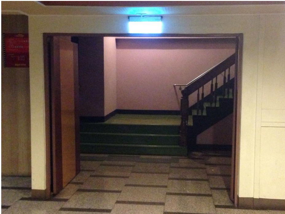
圖 2-2 某電影院避難通道常時關閉式防火門設置情形
