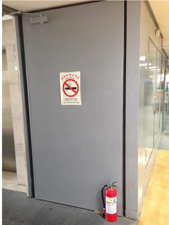
圖 2-9 某辦公場所常時開放式防火門設置情形
