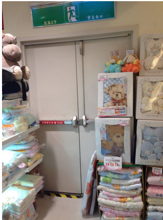
圖 2-6 某商場百貨常時關閉式防火門設置情形 (資料來源：本研究自行拍攝)
