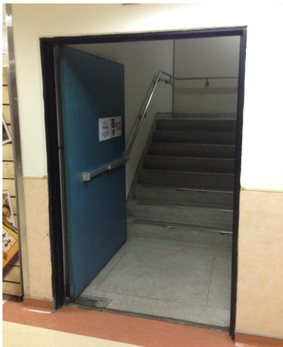
圖 2-7 某醫療照護場所常時關閉式防火門設置情形
