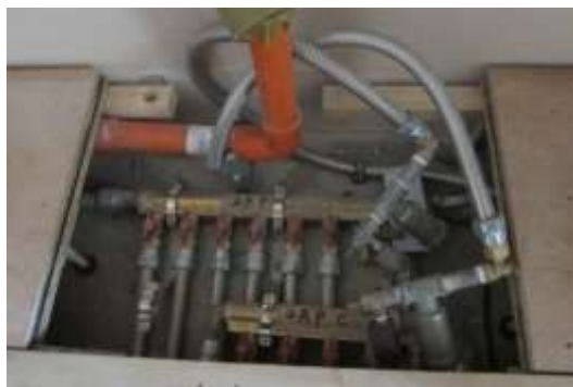
圖 3-18 高架地板管線檢修孔 (圖片來源：本研究拍攝)
