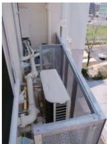
圖 2-35 維修平台內放置管線設備 (圖片來源：UR 都市機構)
