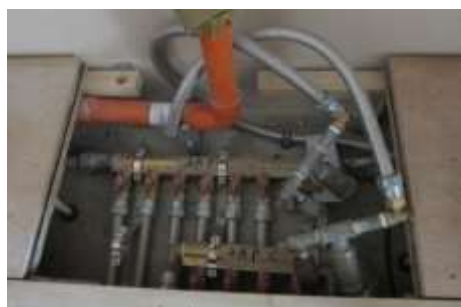
圖 2-52 昇陽麗石高架地板檢修孔 (圖片來源：本研究拍攝)
