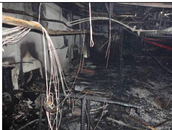
起火建築內部
