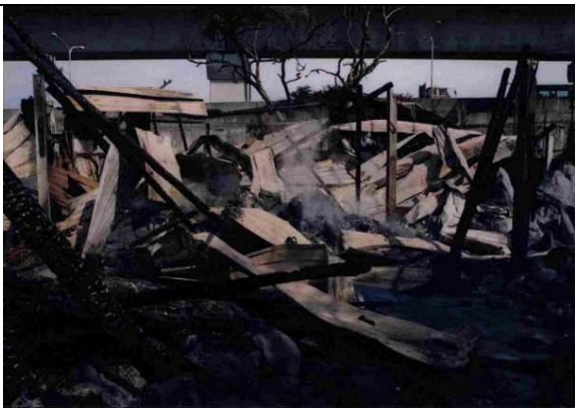
倉庫 1 內部物品靠近北側西端處嚴重燒損
