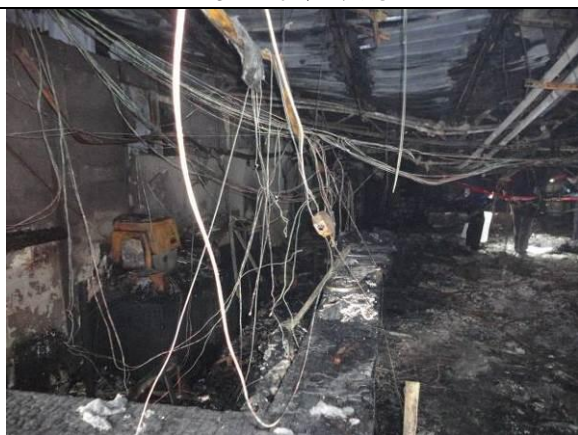
起火建築內部
