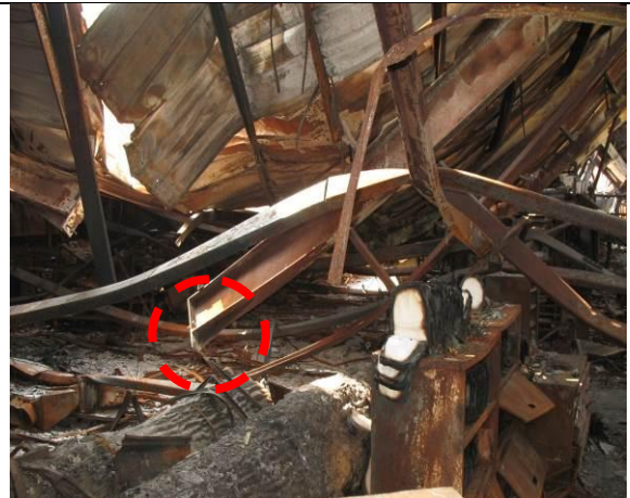
(8)原鋼樑於屋脊接頭處(圓圈)，因螺栓已被拉斷，故屋頂完全塌陷
