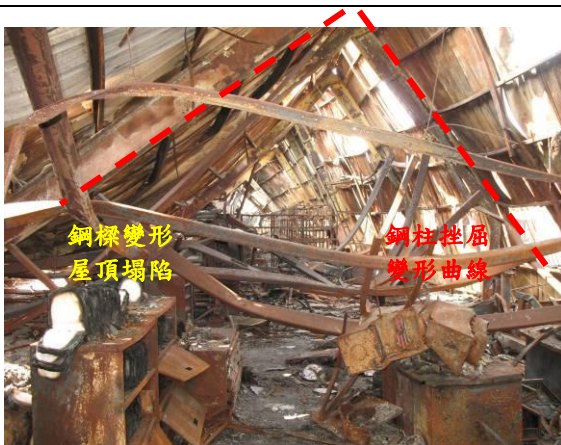
(9)鋼樑與鋼柱產生大量變形(近照)，造成屋頂塌陷、鋼柱挫屈
