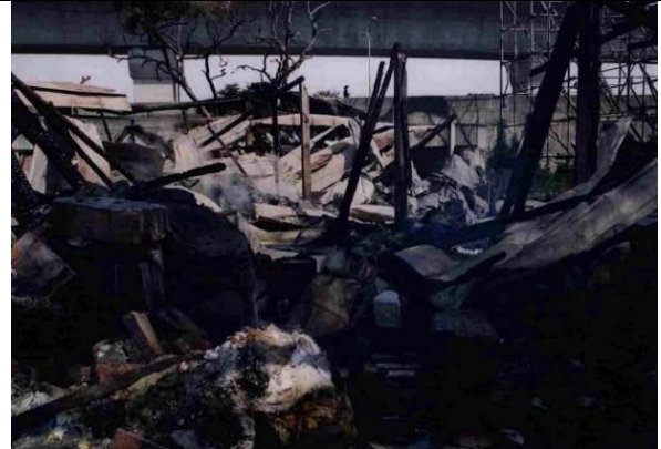
倉庫 1 北側內部物品、牆壁及屋頂鐵皮均受火熱不同程度燒損
