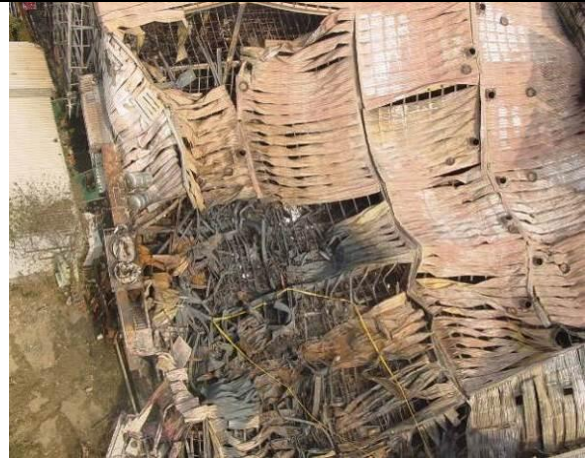
火災後 2 層樓之展示區樓建物多已坍塌
