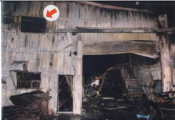
137-4 號火災後南側外觀情形
