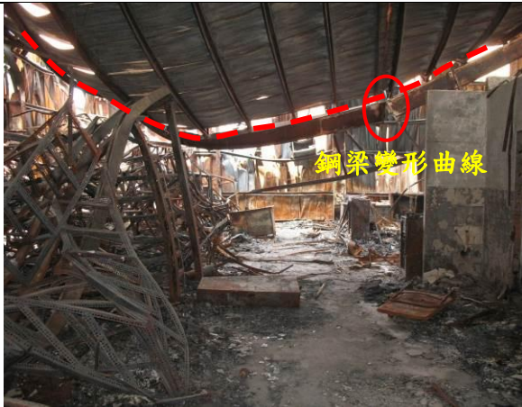
(7)原鋼樑於屋脊接頭處(圓圈)，尚未拉斷，故屋頂未完全塌陷
