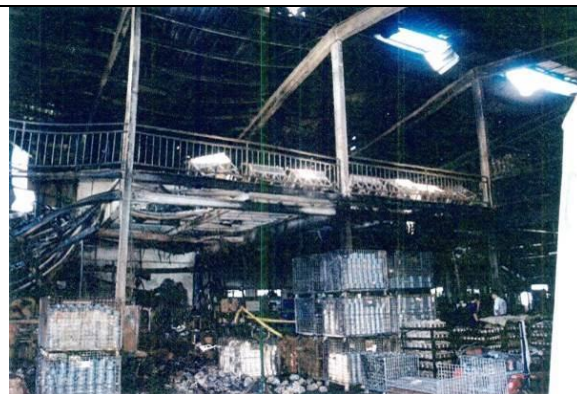
廠房內部 1 樓約中間處所燃燒後情形
