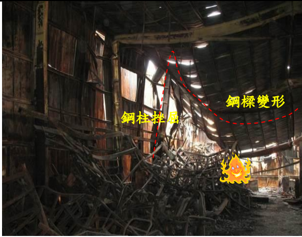
(5)鋼樑與鋼柱產生大量變形，造成屋頂塌陷
