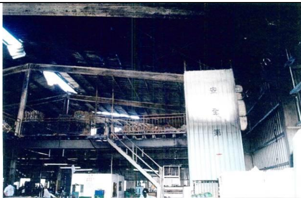
廠房內部 1 樓北側燃燒後情形
