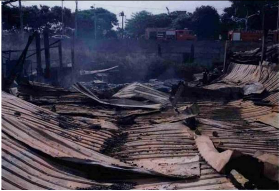
廠房倉庫 2 區域已坍塌，氧化情形較為嚴重
