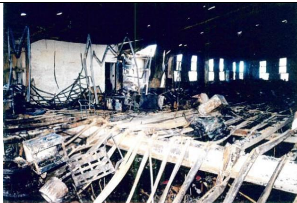
廠房內部 2 樓約中間處所燃燒後情形
