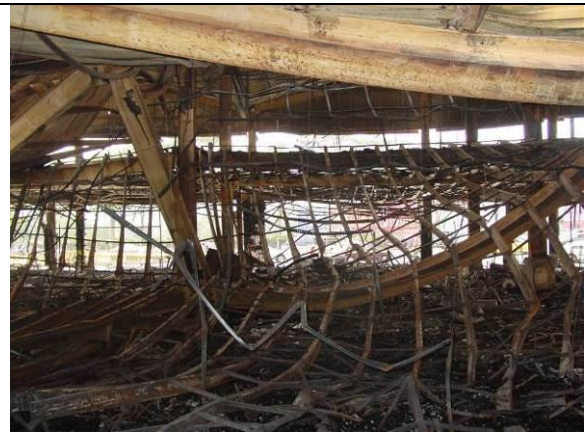
火災後展示區未完全坍塌之內部鋼骨結構亦承受不同程度之火熱影響而變色或變形
