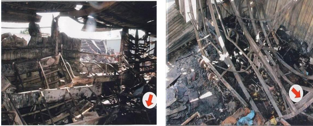
137-4 號西南側上方夾層之 C 型鋼支架及橫樑嚴重變形
