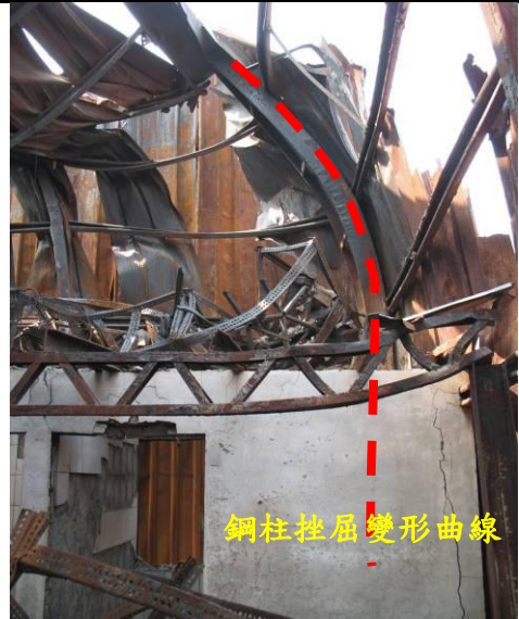
(6)鋼柱挫屈變形(近照)，造成屋頂塌陷
