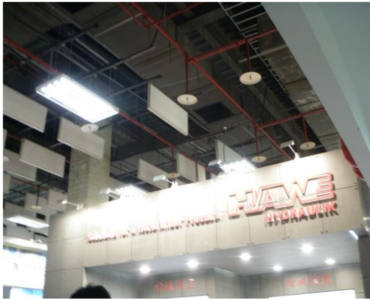
圖 3-27 天花板雜亂標示不清
