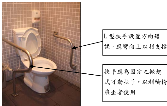
圖 3-2-3 廁所扶手設置不當例
