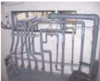
給水配管流量控制台
