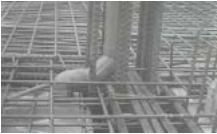
■雨水配管位置不良。
