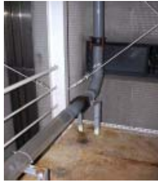
壓克力材質排水橫主管
