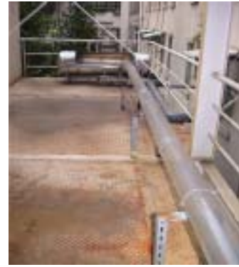
橫主管和間接排水井
