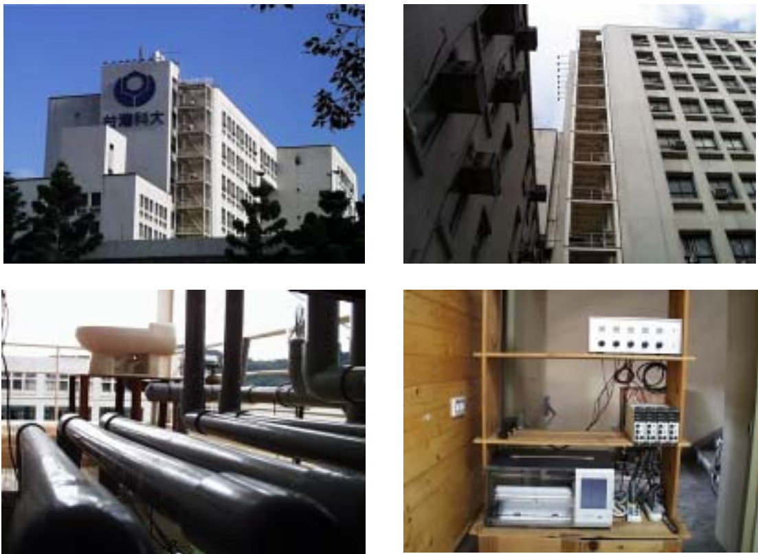
圖 3.2 台灣科大排水實驗塔建置現況照片
