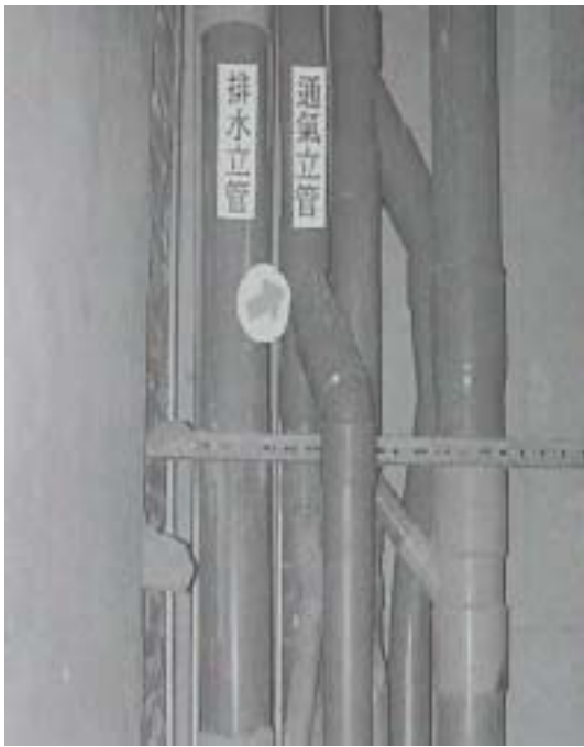
■ 通氣立管銜接位置。
