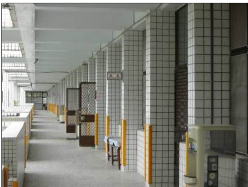
圖 4-5 瑞穗國小 B1 棟二樓走廊立面現況圖 (資料來源：立展工程顧問有限公司)
