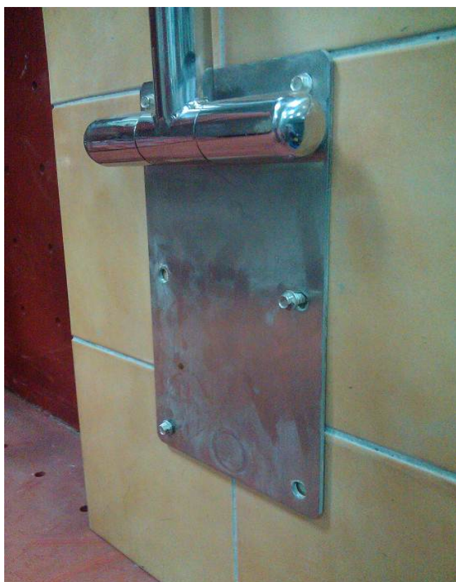
圖 4-19 活動型輔助扶手試件鬆退其錨座固定錨栓 4 支
