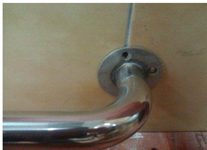
圖 4-17 L 型輔助扶手試件鬆退其錨座固定錨栓 2 支
