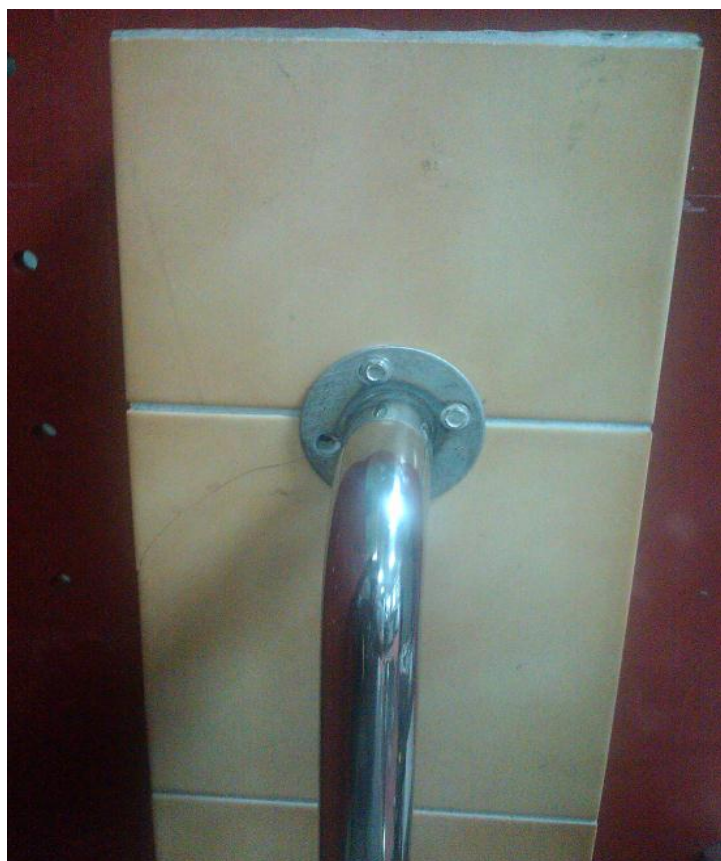
圖 4-16 L 型輔助扶手試件鬆退其錨座固定錨栓 1 支
