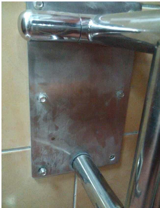
圖 4-18 活動型輔助扶手試件鬆退其錨座固定錨栓 2 支
