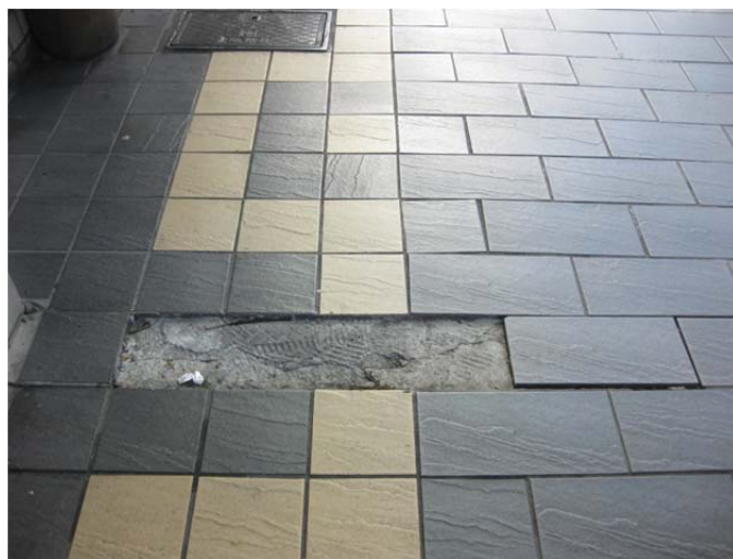
圖附-10鋪面破損
