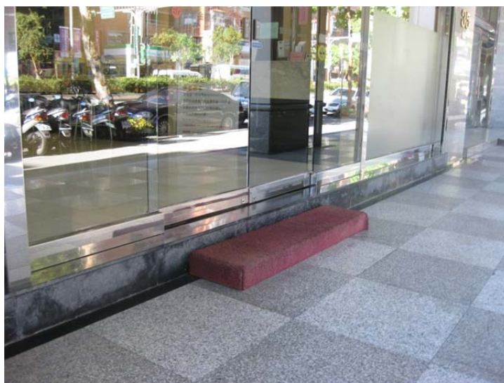
圖附-13永豐銀行出入口未設置斜坡道
