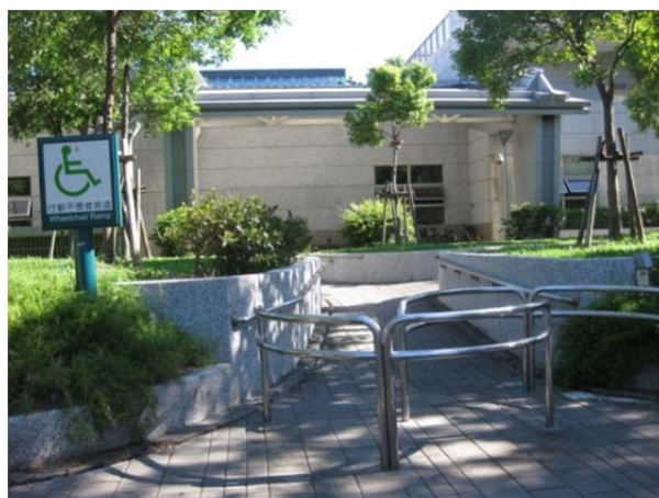
圖附-17 無障礙坡道出入口設置路障
