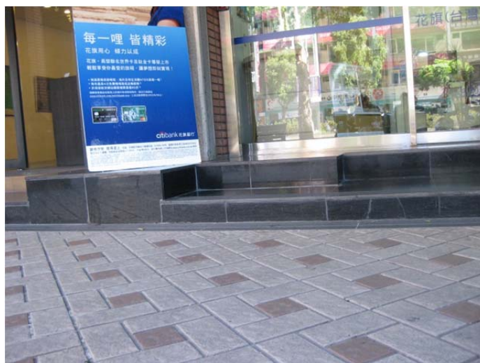
圖附-11花旗銀行出入口未設坡道
