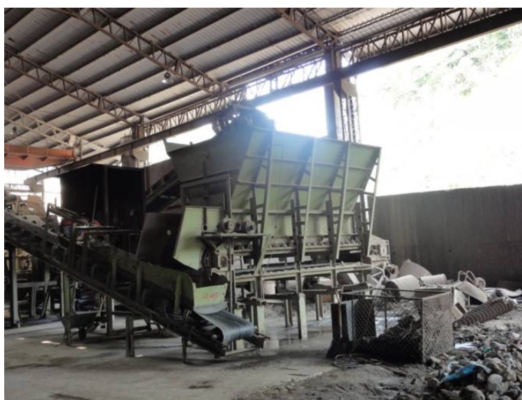
圖 4-17 普通磚生產工廠之破碎處理設備
