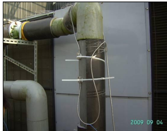
圖36. 將超因波流量計接於出入水管路上
