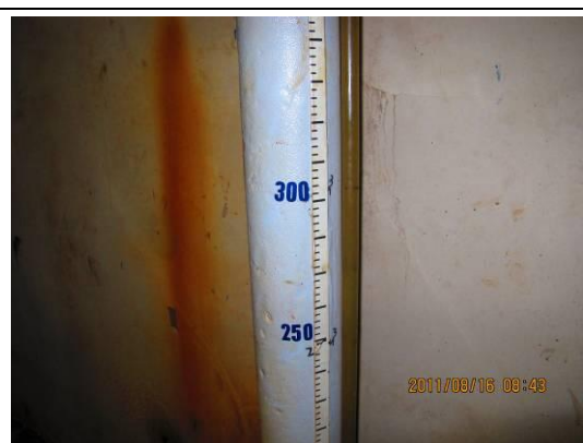
圖51. 改善前儲冰槽水位融量顯示情況
