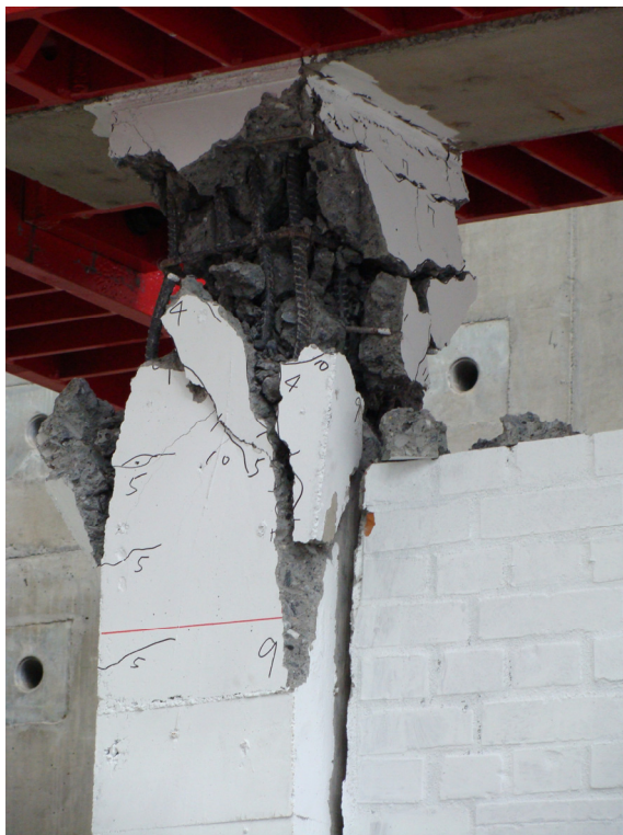
圖 5-26 試體 S4 於位移達 61mm 時混凝土碎裂崩落實驗中止 (資料來源：本研究製作)
