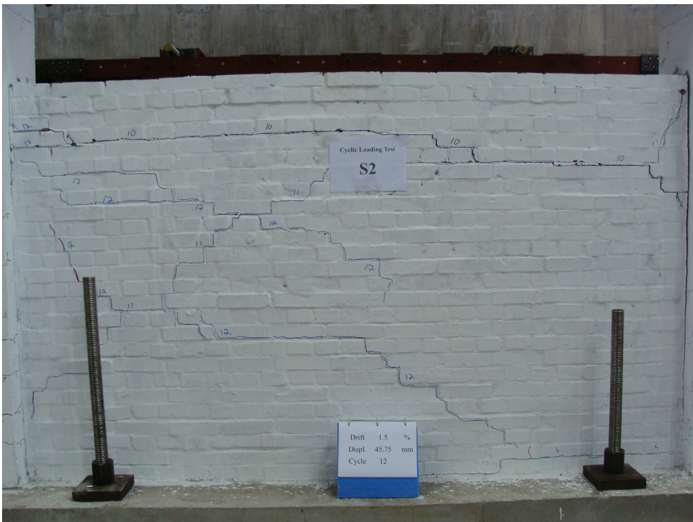
圖 5-12 試體 S2 於位移大於 45.75mm 時磚牆裂隙快速發展 (資料來源：本研究製作)
