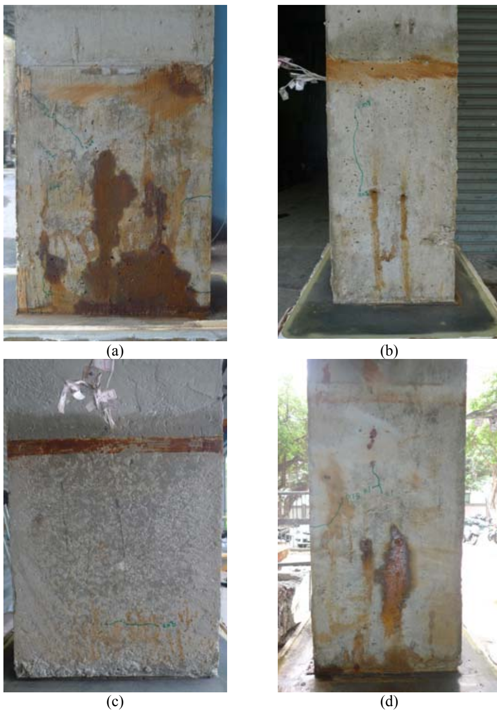
圖 3-20 全尺寸試體橫向鋼筋-重量損失率 3%試體表面的裂縫發展情況：(a)試體前側； (b)試體左側；(c)試體後側；(d)試體右側
