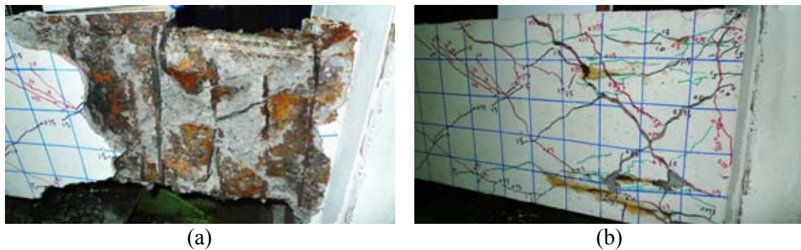
圖 3-55 B t -35 試體破壞情況(a)塑鉸區頂面橫向鋼筋斷裂；(b) 塑鉸區裂縫分布
