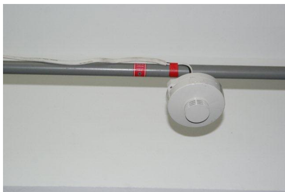
圖 4-23 加裝局限型探測器於取樣孔旁
