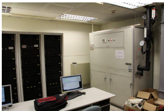
圖 4-15 右側風機之上方進風口(Line B)
