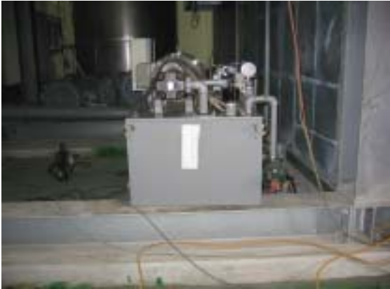
圖七十九 (油壓設備)
