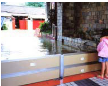
b. 庭院出入口擋水板
