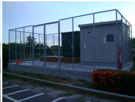
b. 重要機電設備調昇
