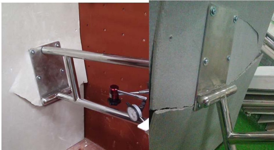
圖 4-11 水泥纖維板承受常態垂直載重試驗所產生之破壞
