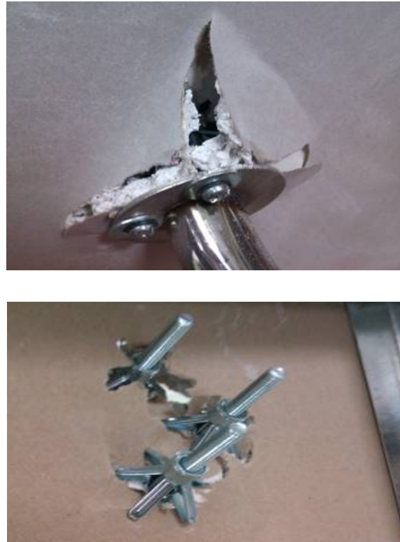
圖 4-7 石膏隔板基材承受垂直載重產生明顯的破壞
