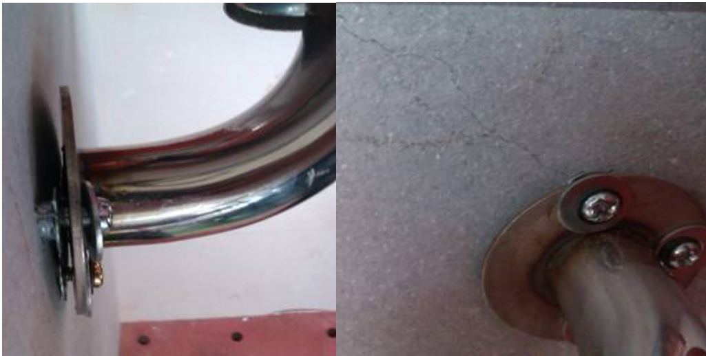
圖 4-5 承受垂直載重產生的錨座離縫與隔板龜裂(纖維水泥隔板基材)
