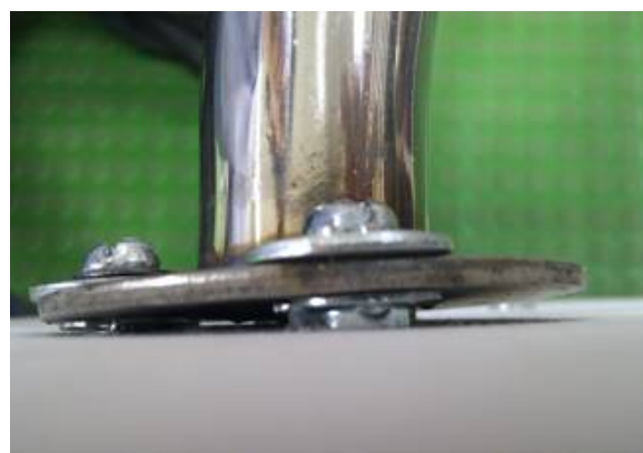
圖 4-4 扶手錨座因承受垂直載重產生的離縫(矽酸鈣隔板基材)
