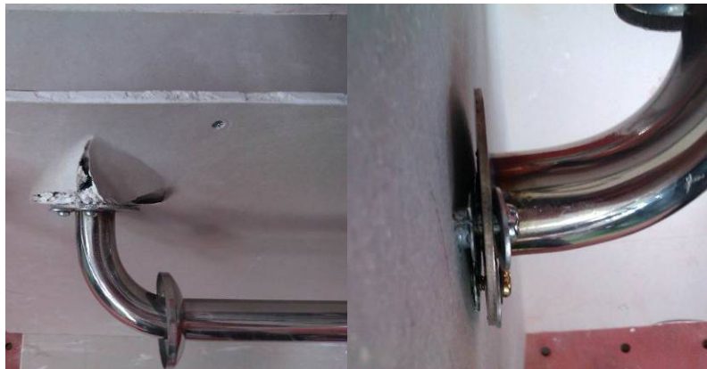
圖 4-1 非常態載重試驗之鬆動鬆動與隔板破損
