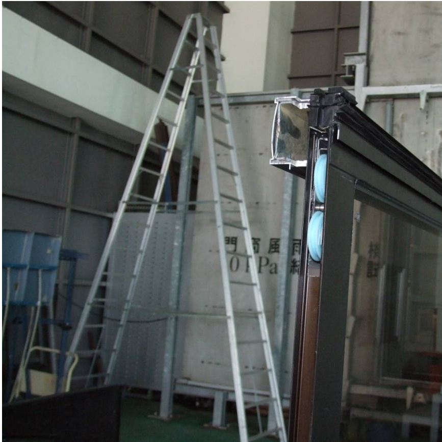
圖2-33 落地鋁窗上的輓輪須定期檢查 資料來源：本研究整理
