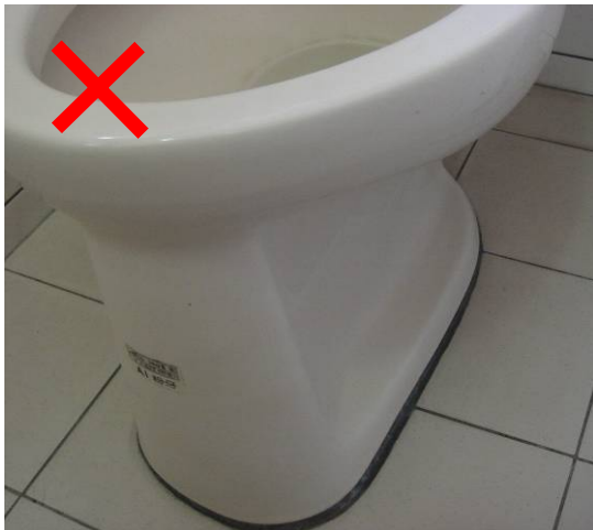
圖 4-14 無錨栓之配件便器
