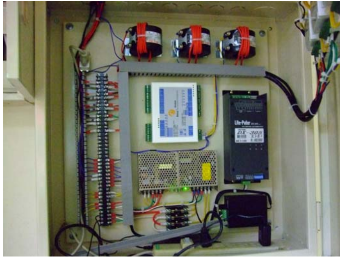
圖26 新裝設之 DDC 控制盤
