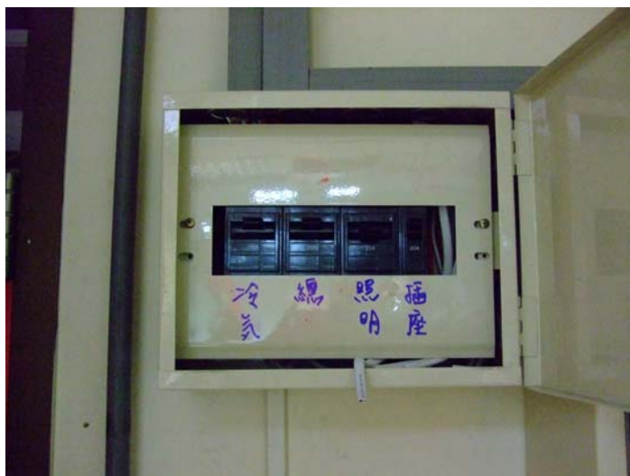
圖25 新裝設之電力盤面
