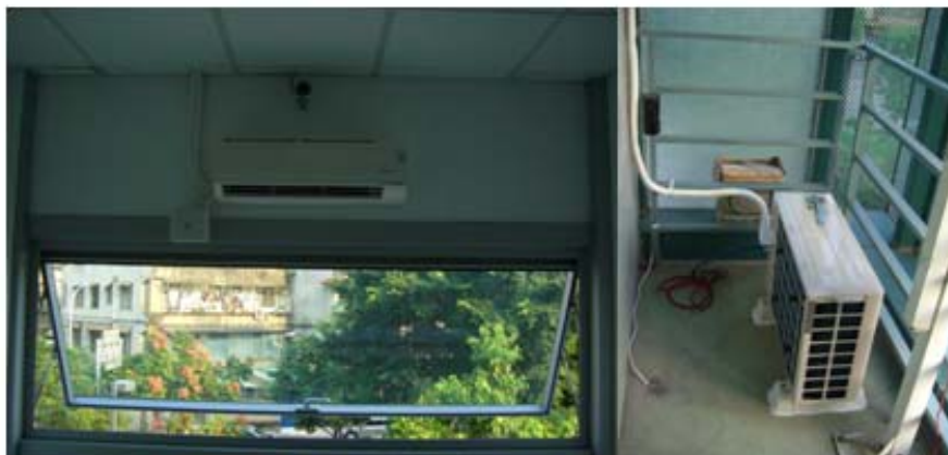
圖92 新設之東元變頻冷氣機
