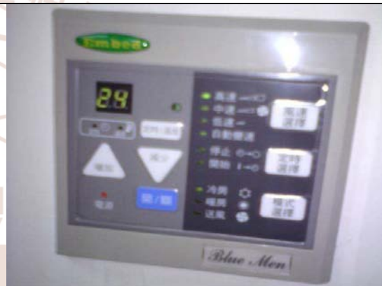
更新後室內送風機用電子式室內型溫度控制器
