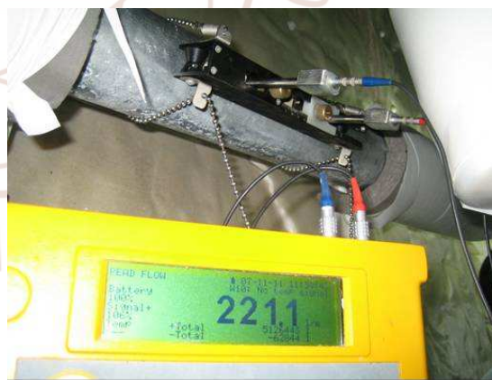
空調箱水量量測狀況圖
