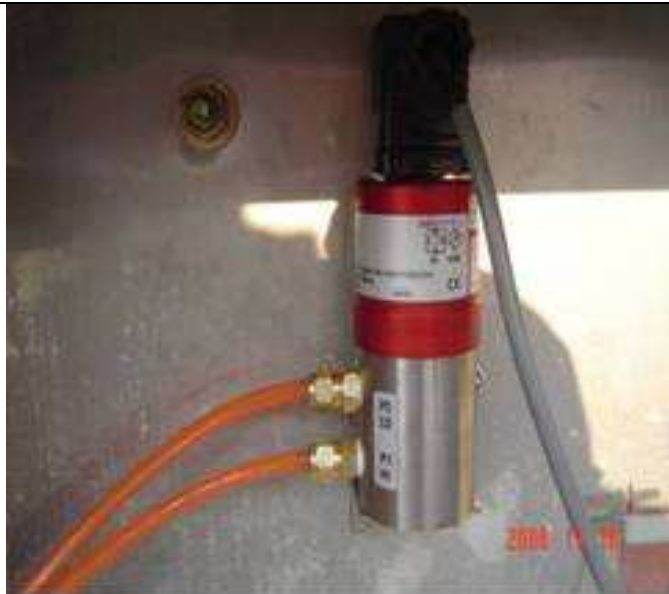
新設水壓差感測器
