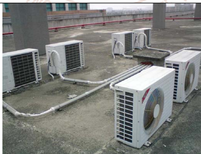
位於頂樓之分離式冷氣主機
