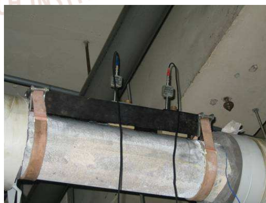
現場主機水量調整
