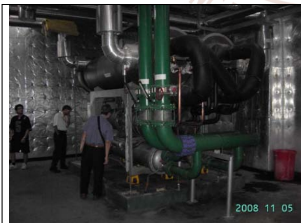
台電大寮訓練所儲冰及空調模式之主機
