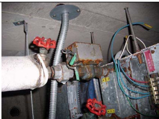
既設室內送風機電動三通閥組
