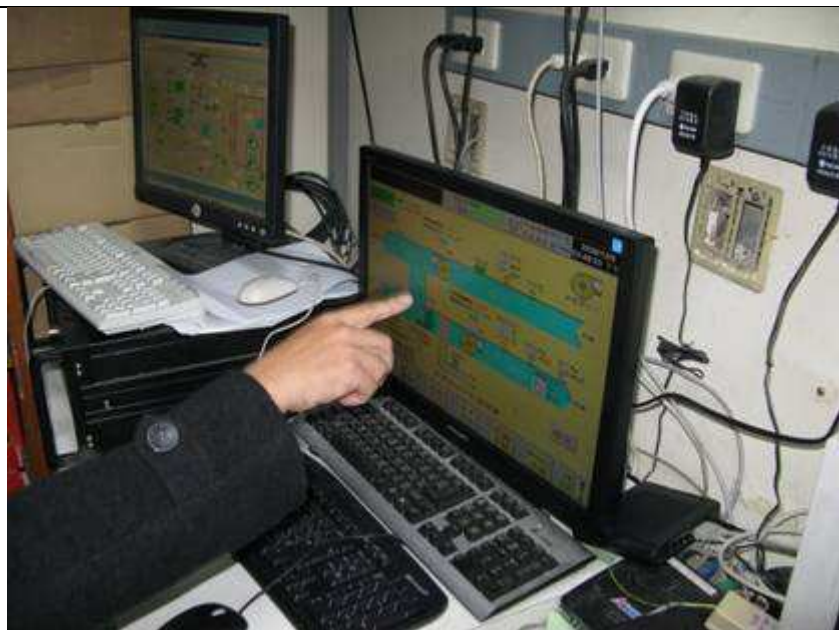
建立空調箱能源管理系統，有效監控新型空調箱節能運轉
