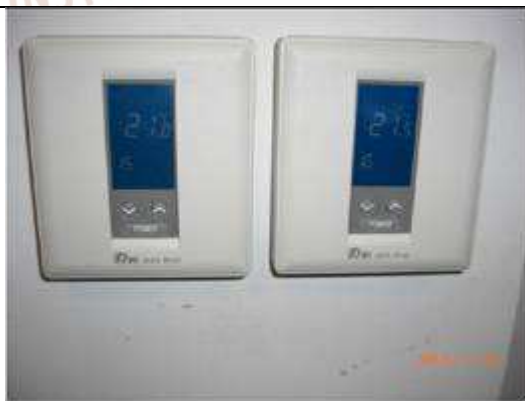
新設之空調送風機(FCU)數位式控制器
