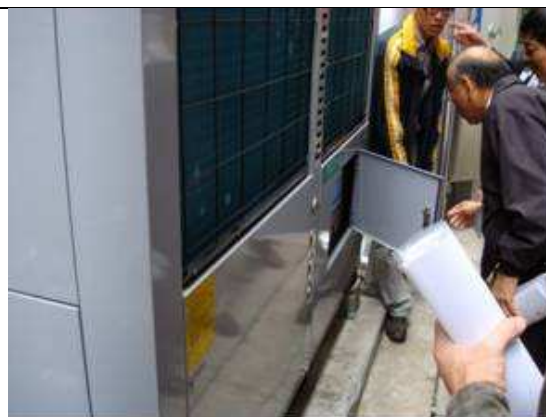
進行之熱泵主機性能查驗
