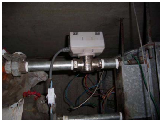
更新後室內送風機電動二通閥組
