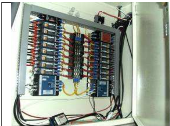
新設之二線式燈控盤
