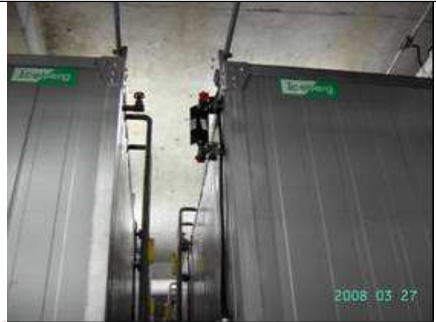
原有之儲冰槽
