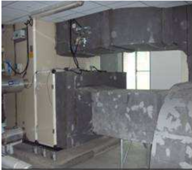
圖 2.34.3 行政院衛生署彰化醫院既有空調箱
