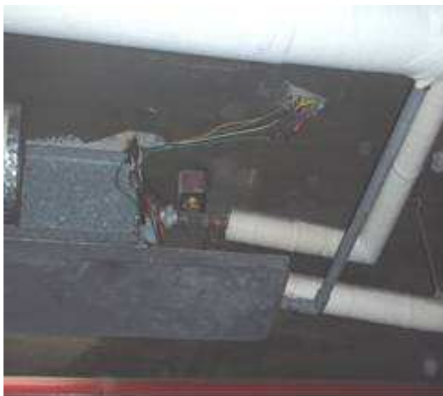
圖 2.30.5 經濟部水利署中區水資源局小型室內送風機
