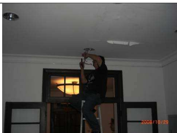
電梯出口處裝設人員感知器
