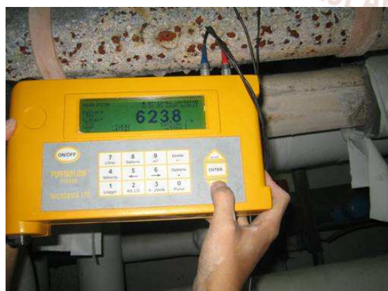
現場主機水量調整
