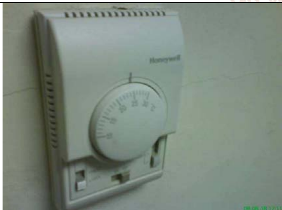
原有既設室內送風機用機械式室內溫度控制器
