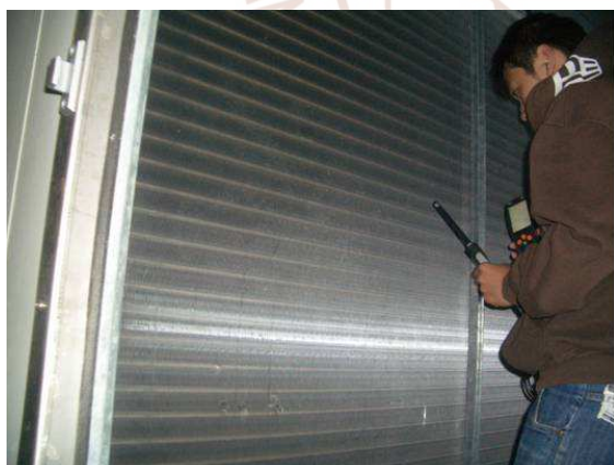
空調箱進風溫、溼度量測狀況圖
