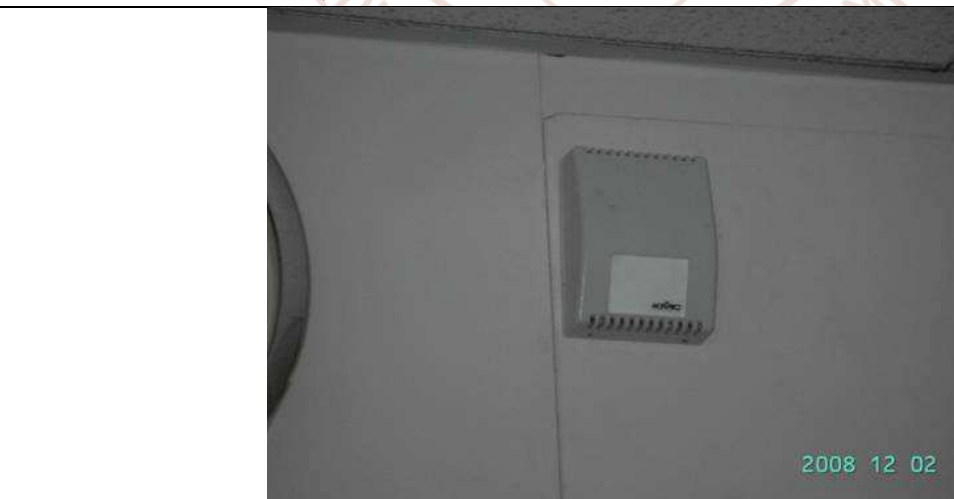
增設之 CO 2 濃度測定計
