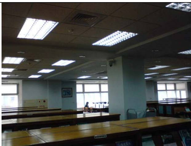
既有之室內照明燈具
