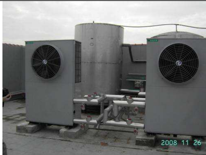
新設之氣冷式熱泵系統
