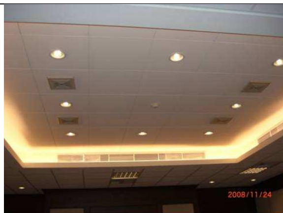
277 會議室改善後之照明設備現況
