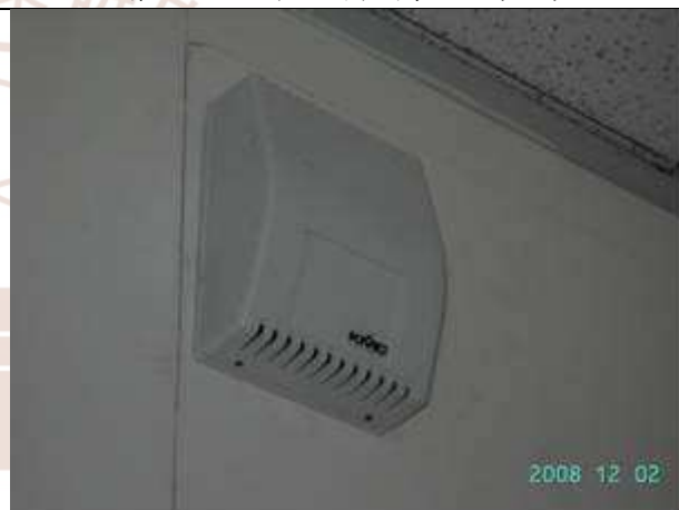
增設 CO 2 濃度偵測裝置 (二)
