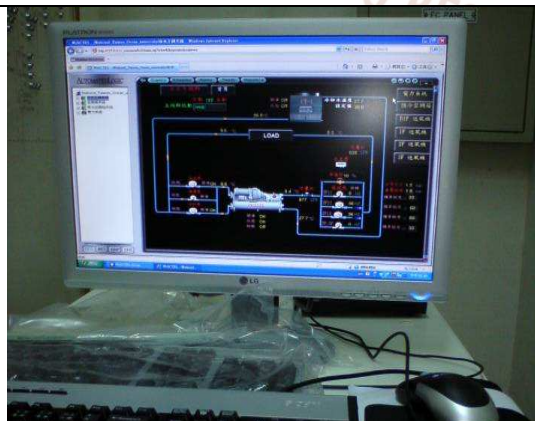
中央監控電腦設備
