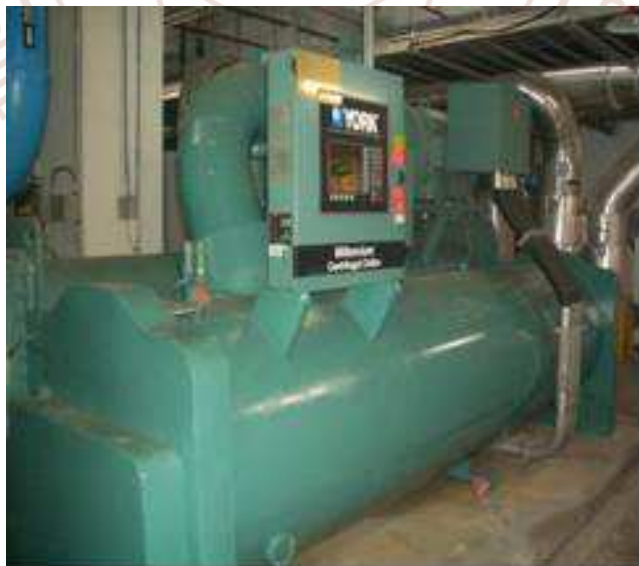
圖 2.34.2 行政院衛生署彰化醫院既有冰水主機
