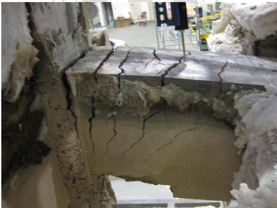
圖 4.55 (b) SCC5 殘餘極限承載試驗試體破壞照片 (2)
