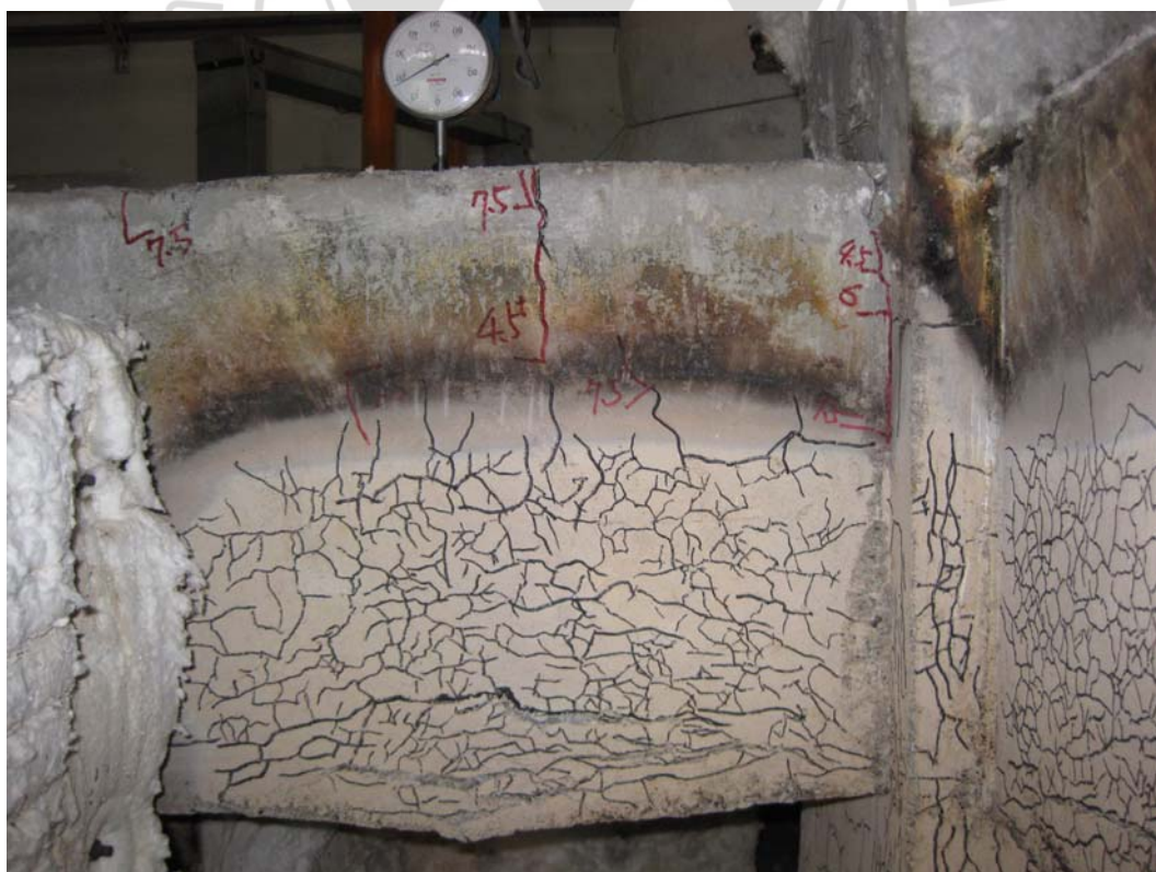
圖 4.50 NC3 殘餘極限承載試驗試體裂縫發展情形
