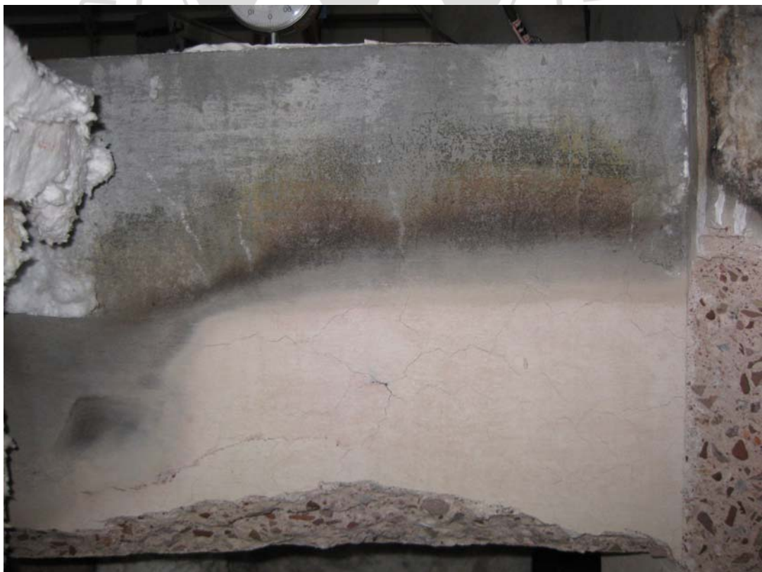
圖 4.34 (b) SCC3 試體主梁火害後表面裂縫
