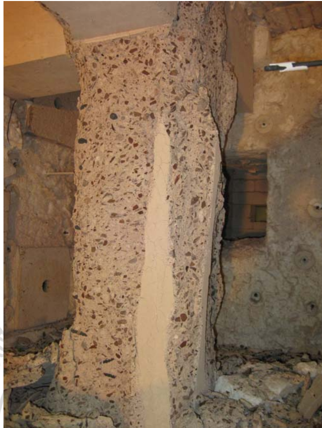
圖 4.37 (a) SCC5 試體柱下端火害後表面裂縫
