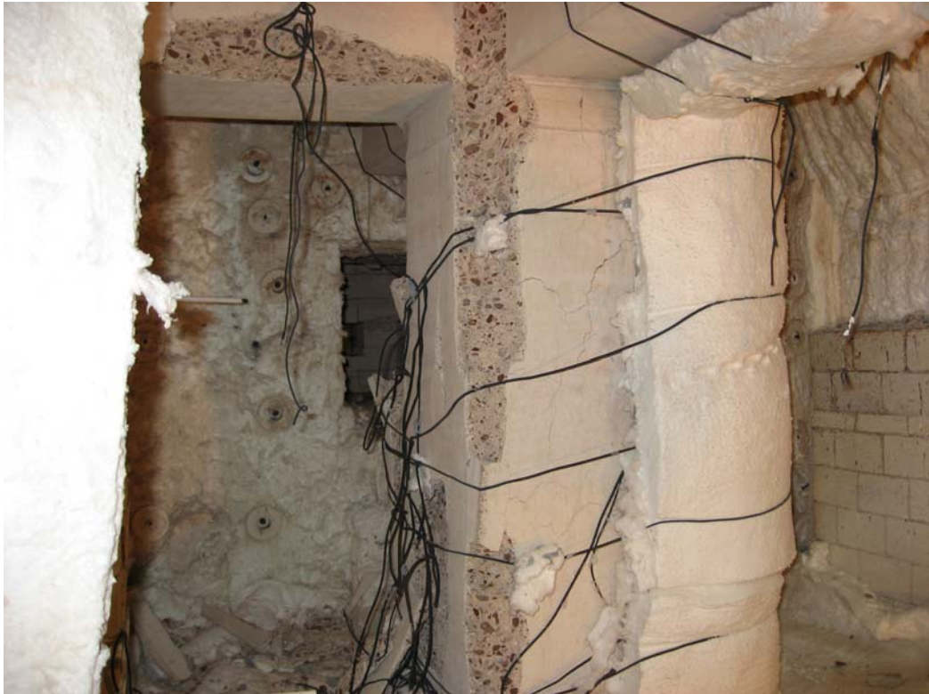
圖 4.34 (a) SCC3 試體柱下端火害後表面裂縫
