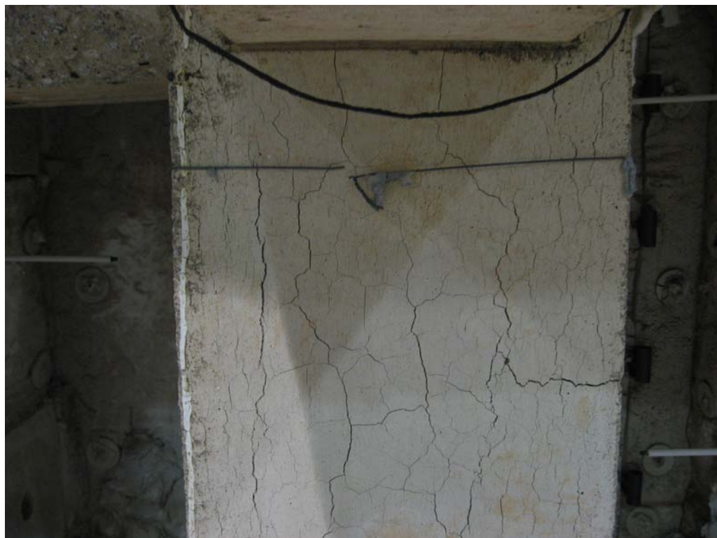
圖 4.30 (a) NC2 試體柱下端火害後表面裂縫
