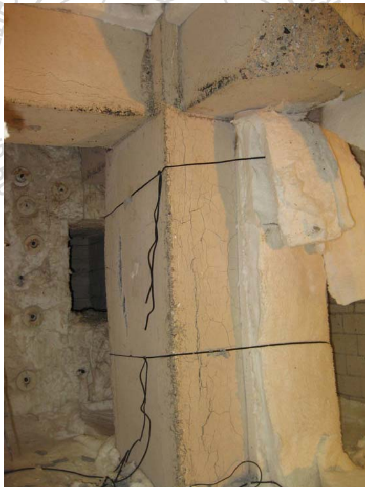
圖 4.32 (a) NC3 試體柱下端火害後表面裂縫
