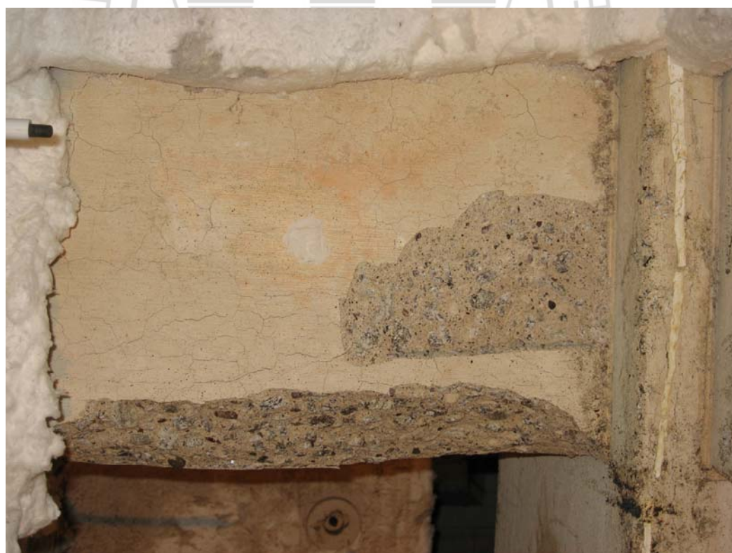
圖 4.30 (b) NC2 試體主梁火害後表面裂縫
