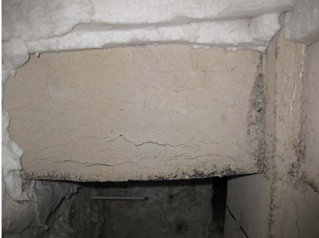
圖 4.32 (b) NC3 試體主梁火害後表面裂縫
