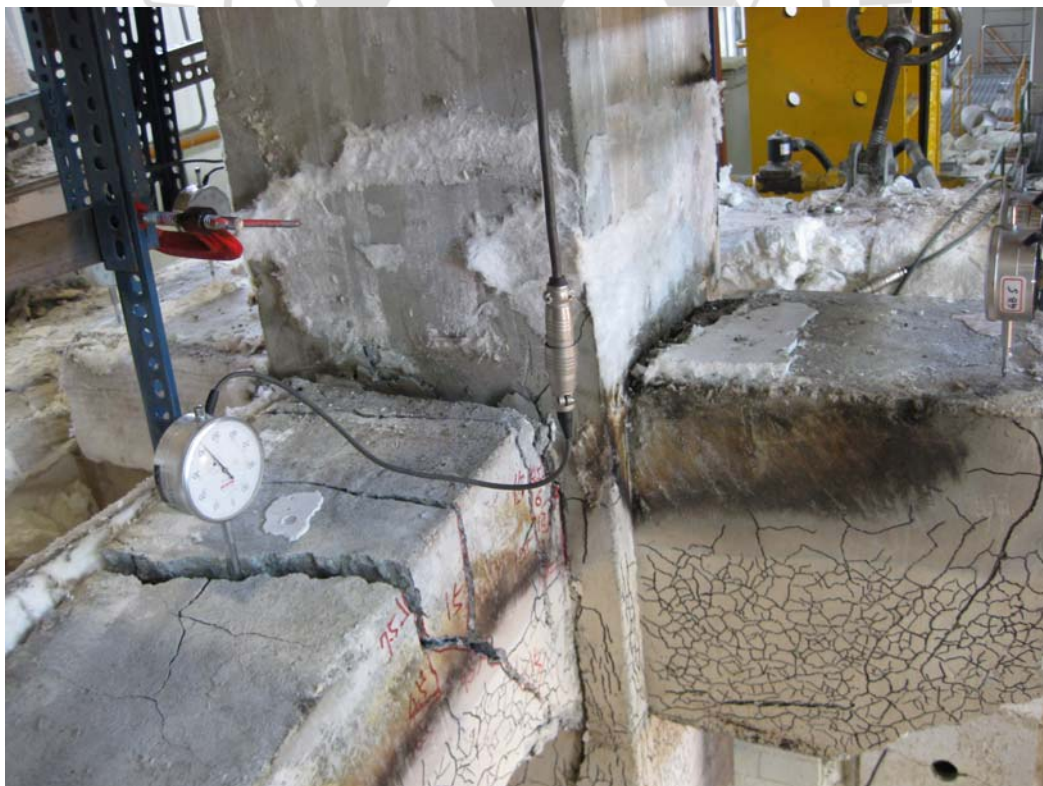
圖 4.51 (b) NC3 殘餘極限承載試驗試體破壞照片 (2)
