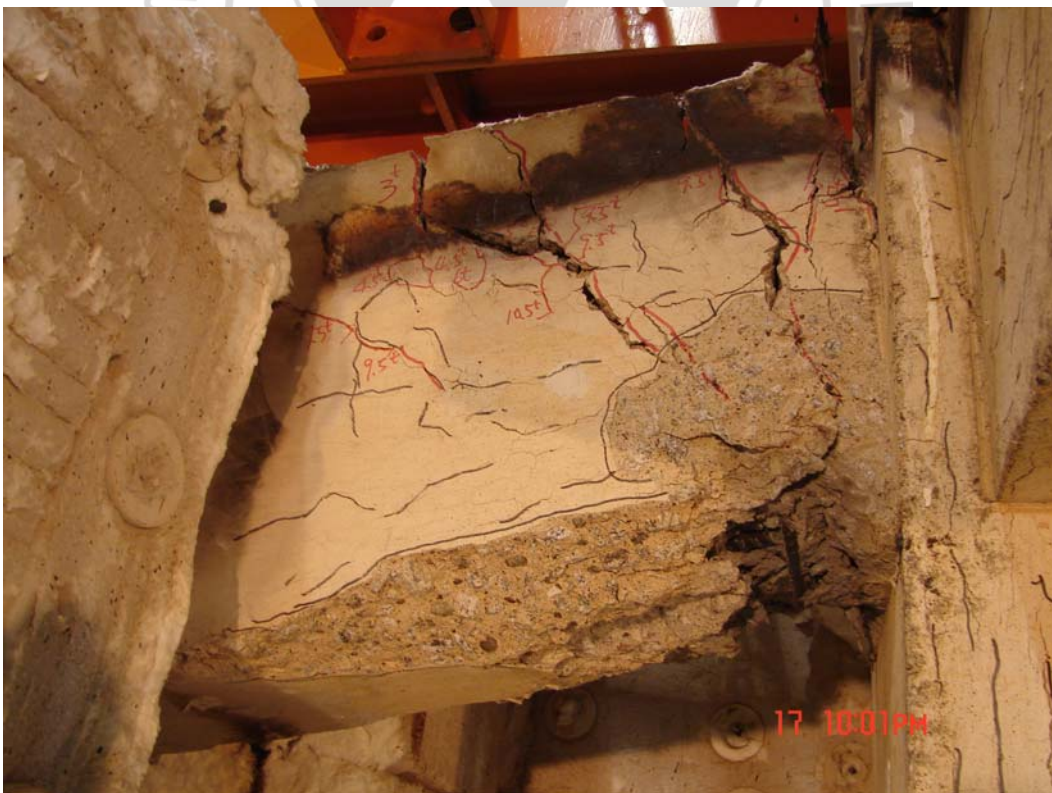
圖 4.49 (a) NC2 殘餘極限承載試驗試體破壞照片 (1)
