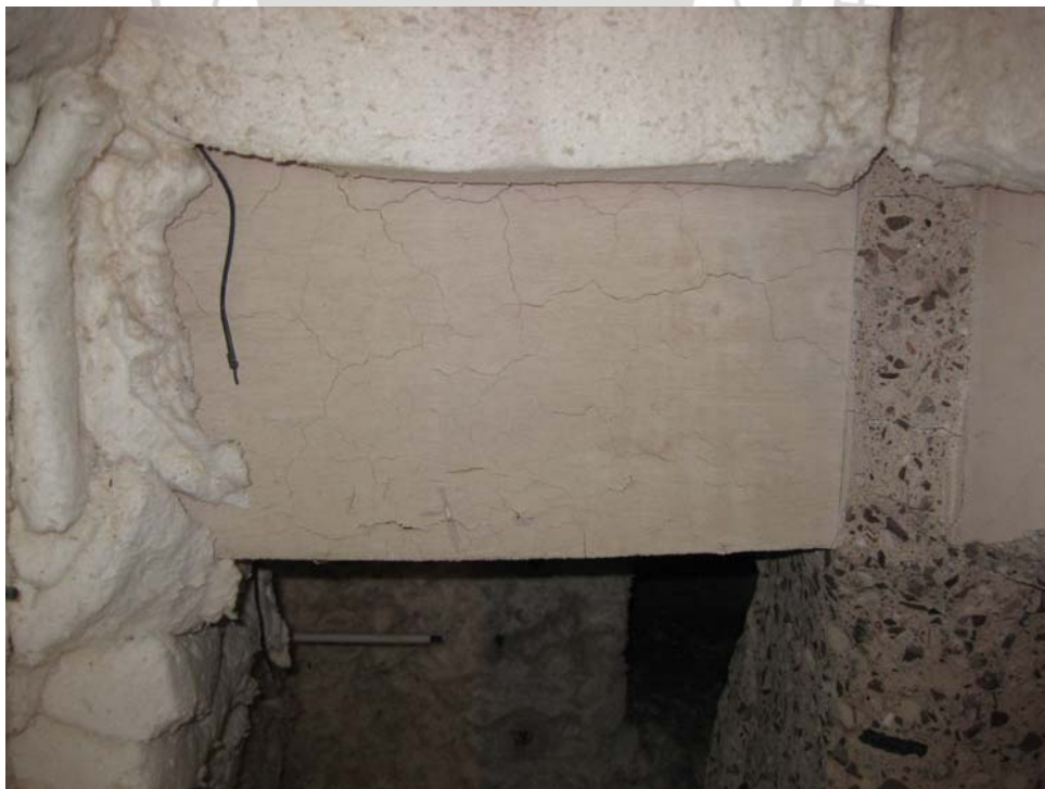
圖 4.37 (b) SCC5 試體主梁火害後表面裂縫
