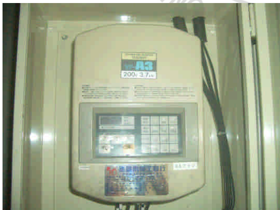
圖 2-12 排煙啟動控制器
