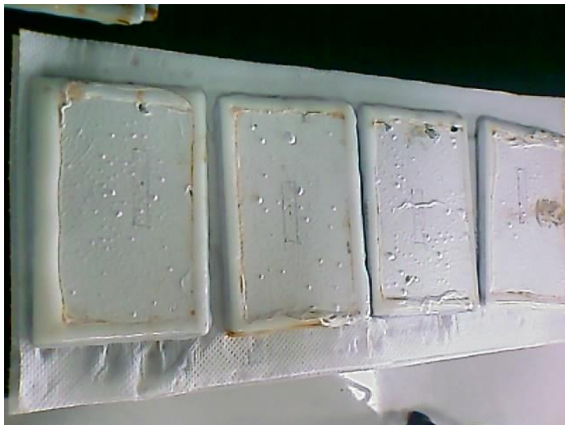
圖 6-4 鋼板基材防火漆塗裝經鹽霧劣化 2000 小時情形 (本研究自行整理)
