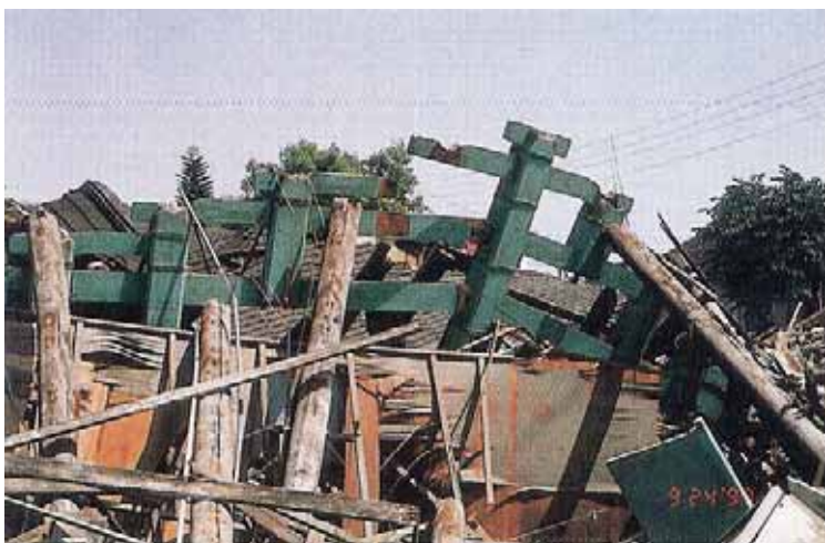
圖 3-7 霧峰林宅在九二一地震中崩塌的狀況
