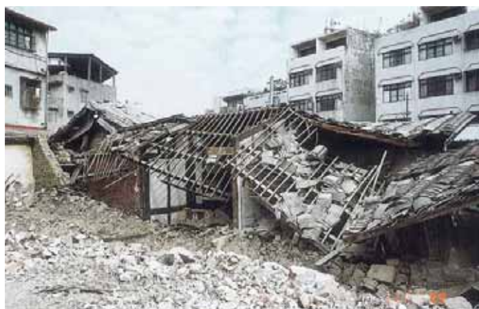
圖 3-12 由於變形不同步導致桁條脫落屋頂崩塌
