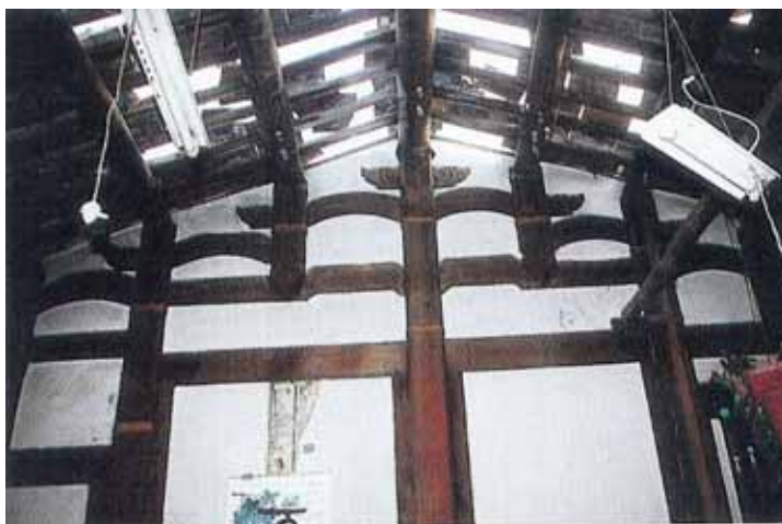
圖 3-11 穿鬥式木構架屋頂屋瓦被甩落
