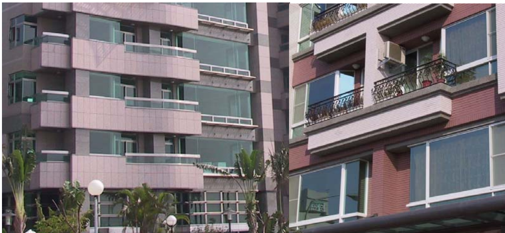
圖 2.6 目前流行的封閉開窗方式，不但造成通風障礙，更造成能源浪費
