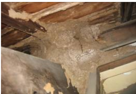
圖 3-15 電源室建築內部附壁白蟻築巢
