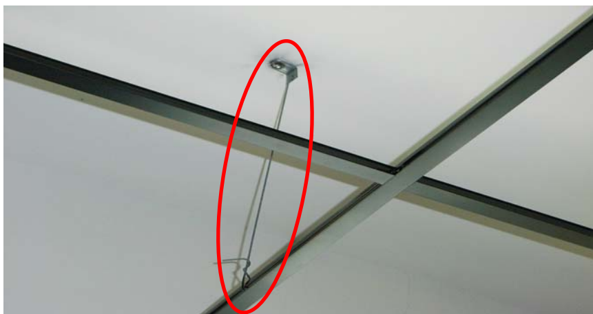
圖 2-1 明架天花板及吊筋
