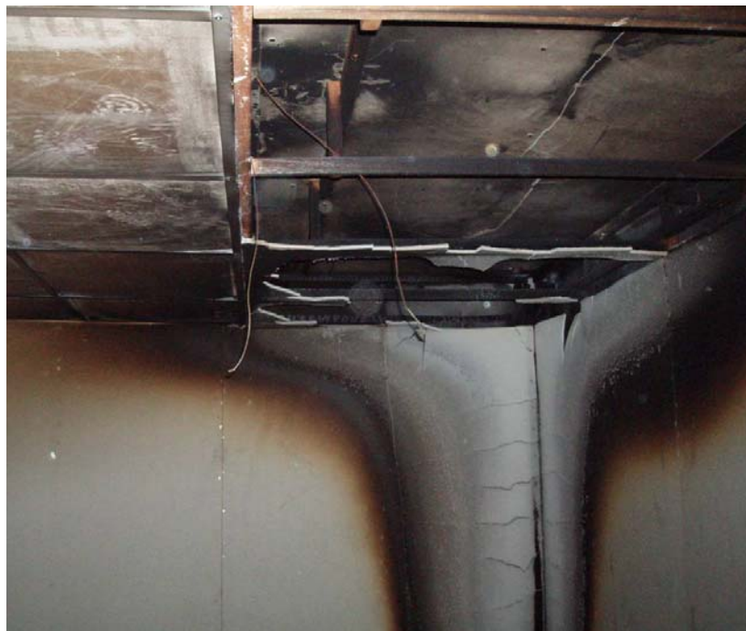
圖 3-6 天花板版材燒穿及木角材崩塌
